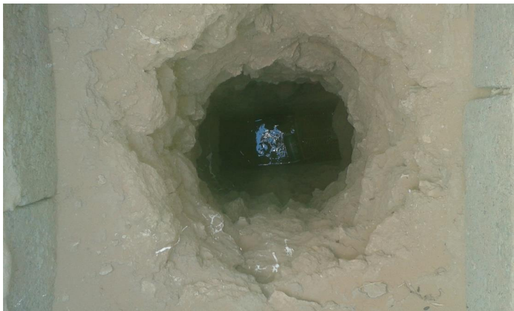
Fig. III.10. Un puits du tronçon de drainage d'une foggara de Zaouiet Kounta (kantaoui, 2016)
