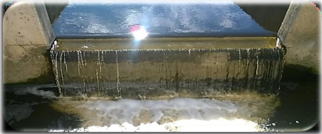
Figure II.9 : la sortie des eaux épurées d'après chloration (source STEP Ain-Temouchent).
