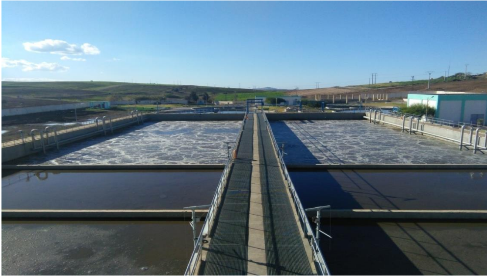
Figure II.5 : bassin biologique (source STEP-Ain Témouchent).
