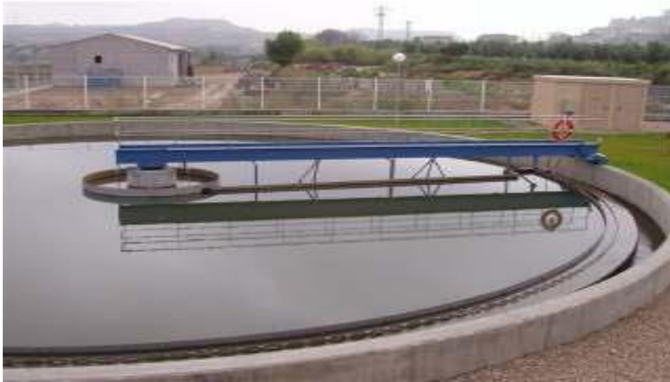
FigureII.7 : Exemple d'un clarificateur (source STEP-Ain Témouchent)
