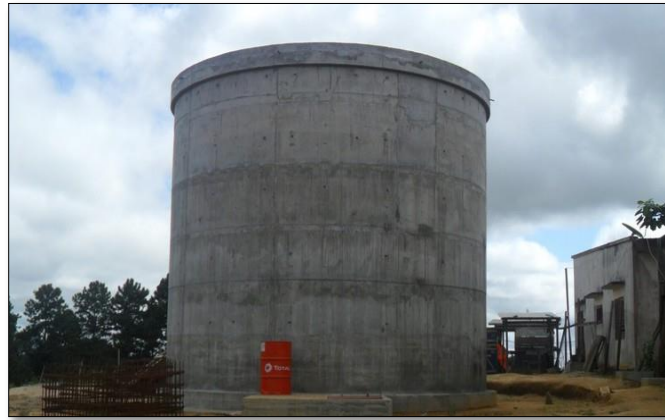
Figure I-7 : Réservoirs en béton ( Source : https://www.udemy.com/course/modelisation-dun-reservoir-deau-en-beton-arme/ )
