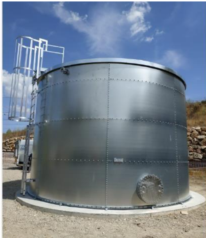
Figure II.3 : Réservoir d'eau potable [22]
