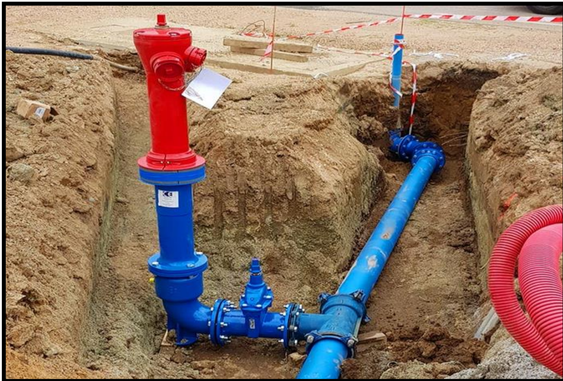
Figure VI. 12: Le poteau d'incendie.
