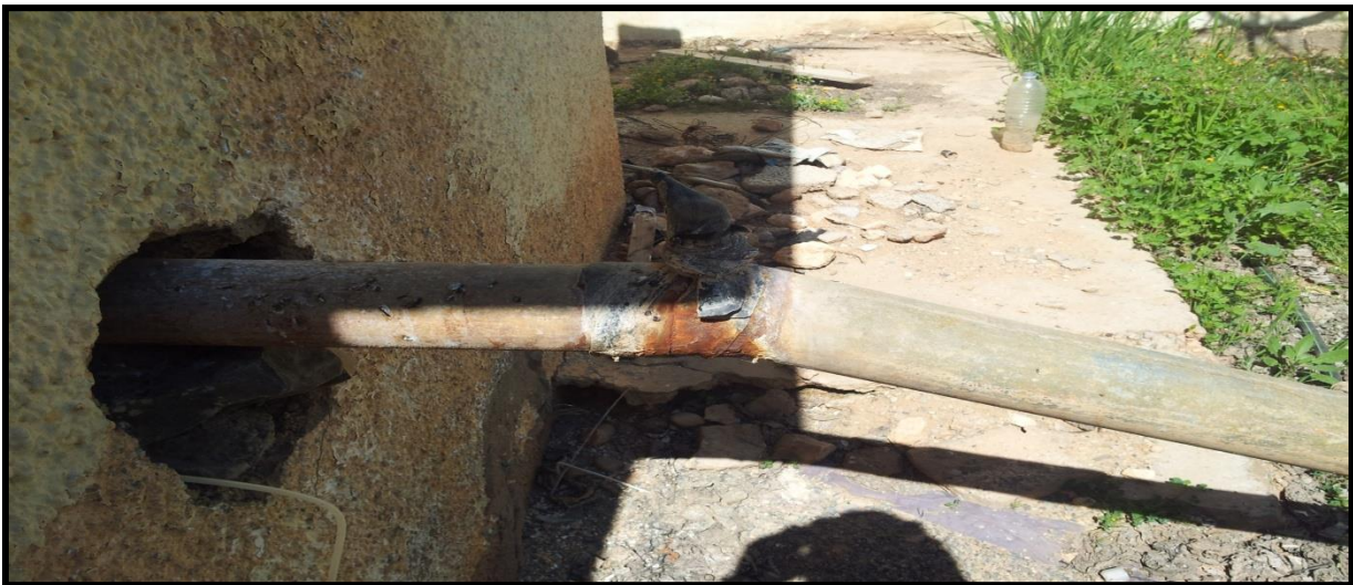
Fig III.8. conduite de distribution sortie du reservoir (DRE MOULEY SLISSEN 2023)
