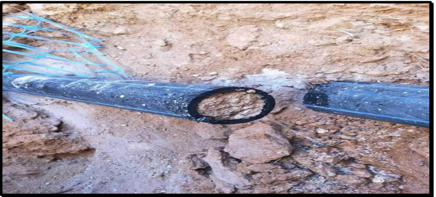
Figure III.5. Conduite en PEHD de 63mm (DRE MOULEY SLISSEN 2023)
