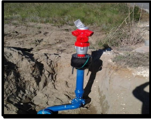
Figure VI.12 : Poteau d'incendie (Source : https://www.alertincendie.fr/details-installation+et+maintenance+des+poteaux+incendie-45.html )
