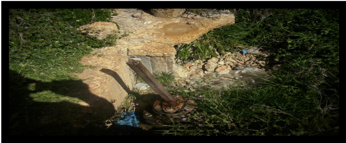
Fig III.8. Vanne de sectionnement pour distribution sans protection (DRE MOULEY SLISSEN 2023)
