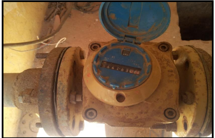
fig III.8. débitmètre en panne (DRE MOULEY SLISSEN 2023)
