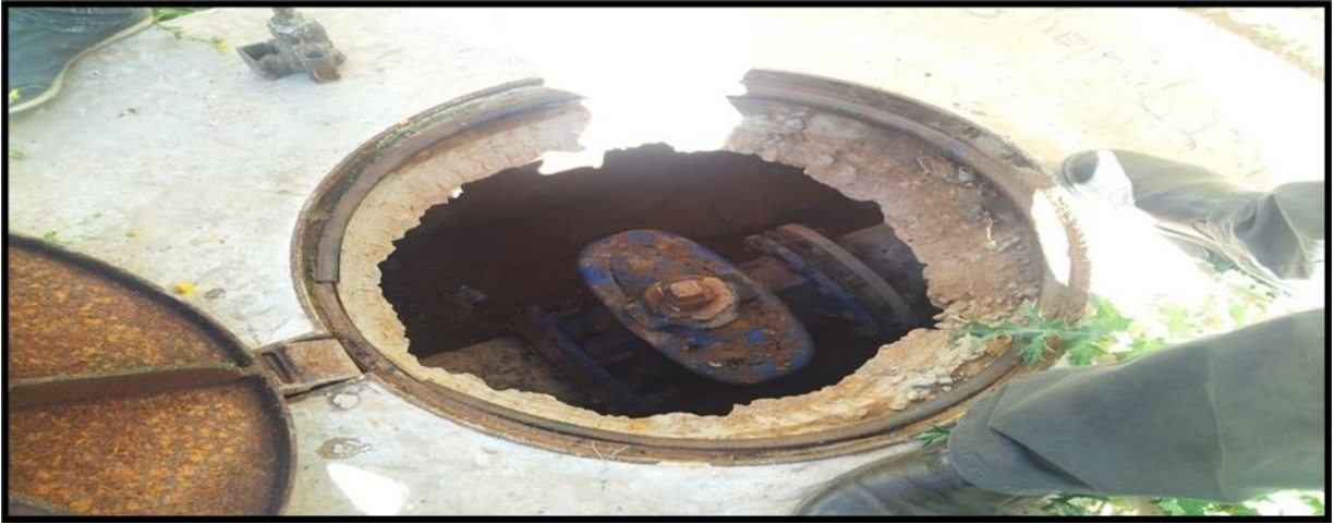
Figure III.3. Regard et robinet vanne 160mm. (DRE MOULEY SLISSEN 2023) .
