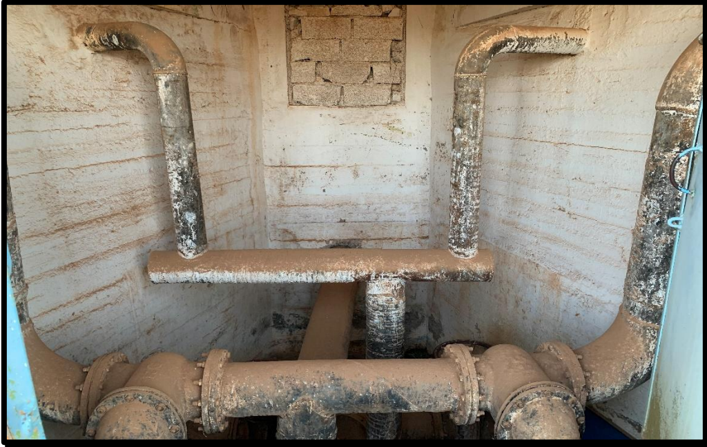
Figure IV-13 : État de la chambre des vannes du réservoir 2*900 m 3
