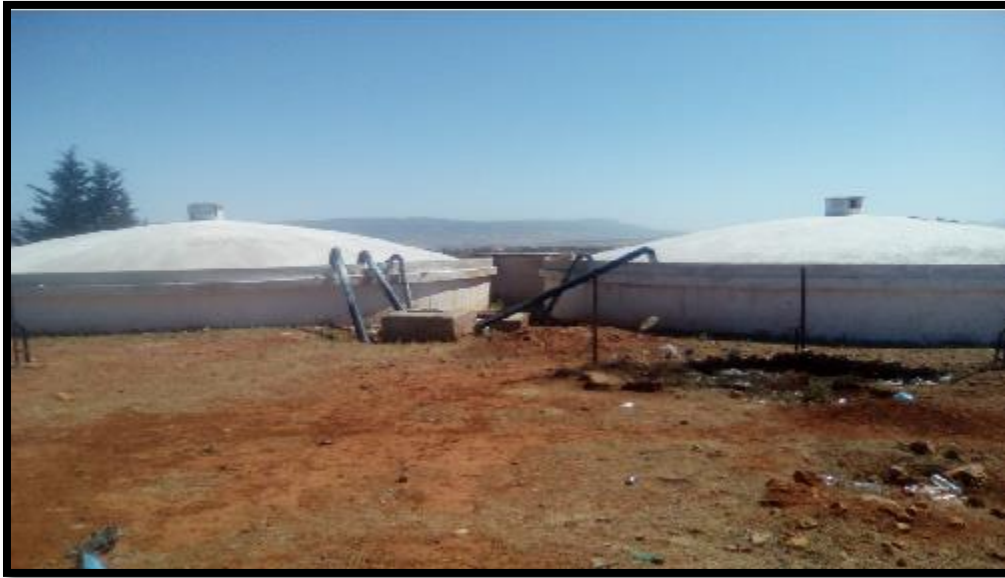
Figure IV-1 : Réservoir 2*900 \text{ m}^3
