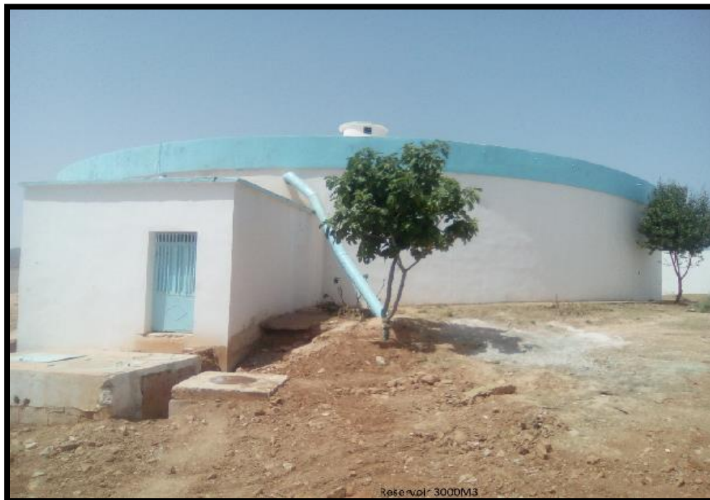
Figure IV-2 : Réservoir 3000 \text{ m}^3
