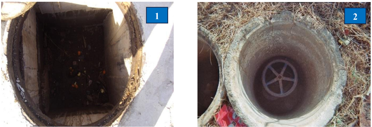
Figure III. 3 : l'état physique des équipements du réseau. (ADE, 2023)
