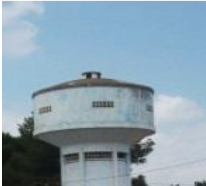
Figure III. 4 : Réservoir Existant d'El Alaimia de 500 m 3 . (ADE, 2023)
