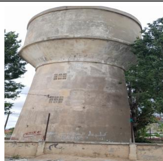
Figure I.2: Château d’eau 150m3
