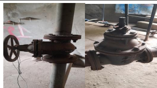
Figure III.7 : les équipements du château d'eau 150 m 3
