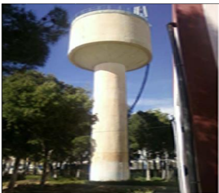
Figure I.4: Château d’eau 300 m3
