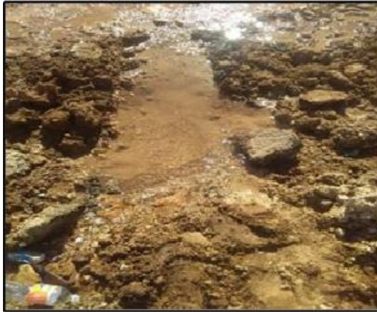
Figure 01:Photos de fuite dans une partie de l'adduction de sidi bendiaf (source ADE Remchi)
