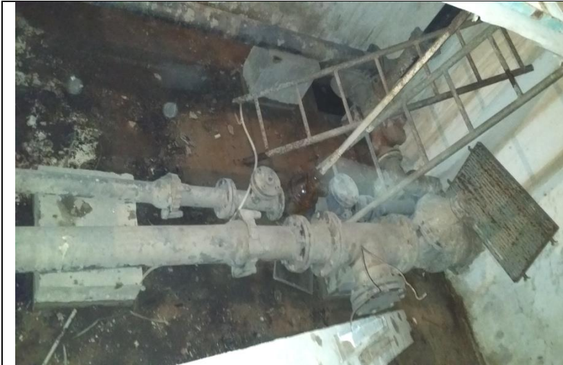
Figure III.14 : vue de l'intérieur de la chambre des vannes du reservoir de volume 300 m3 de Djlouli « Zaouia Centre »
