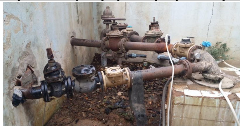
Figure III.3 : vue de l’intérieur du forage Chenafi « F3 »
