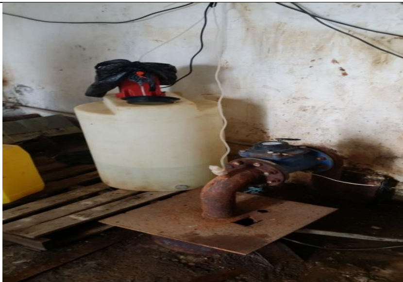
Figure III.5 : vue de l'intérieur du forage Djoulou « F9 »
