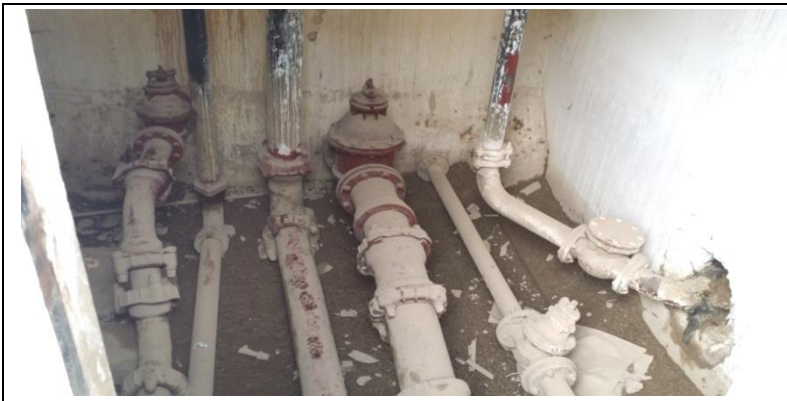
Figure III.13 : vue de l'intérieur De la chambre des vannes du reservoir de volume 150 M3 « Rue Med Saidani »
