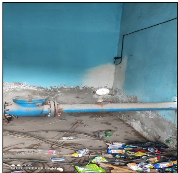
Figure III. 2: Outil de mesure et vanne en bon état au niveau du forage Chebli (2022)
