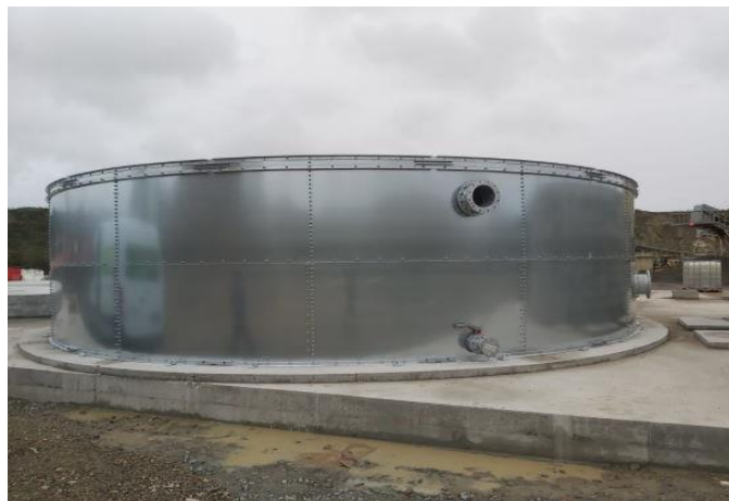
Figure IV.01 : Réservoir métallique pour eau potable et eau de process.
