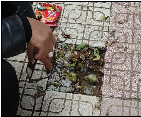
Figure III.17 : Fuite importante au niveau de Chebli nord (2022)
