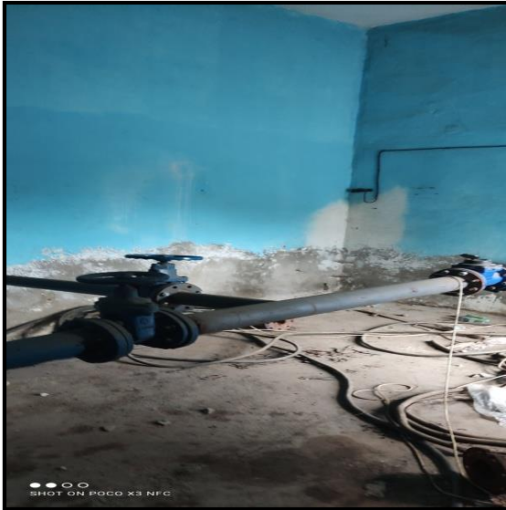
Figure III. 3 : Vannes, clapet et conduite Chebli 1 (2022)
