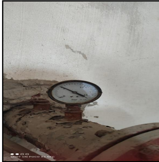
Figure III. 4 : Corrosion considérable des conduites forage Chebli 1 (2022)
