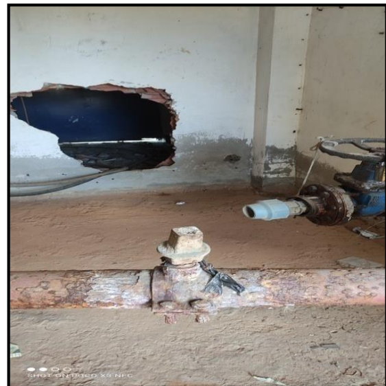
Figure III.6 : Câble électrique non protégé Chebli 2 (2022)
