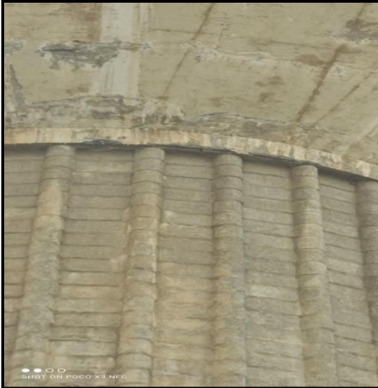
Figure III.13 : Dégradation des parois (2022)
