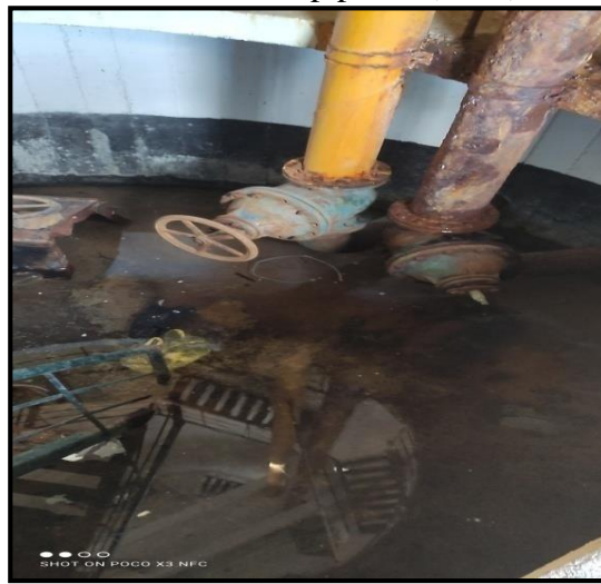
Figure III.16 : Conduite de vidange corrodée (2022)
