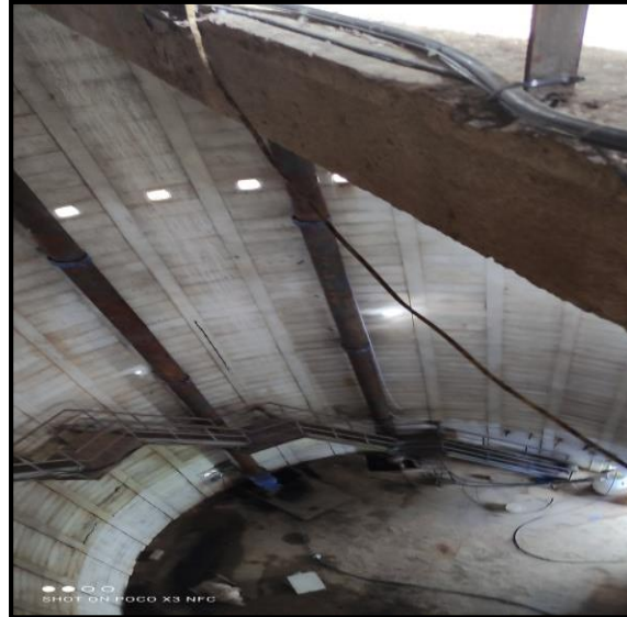
Figure III.14 : Etat des conduites de Distribution et de trop plein (2022)
