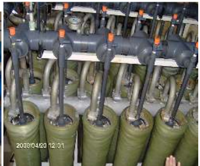
Les membranes de la station de dessalement d'EL GAZAOUAT (Tlemcen)
