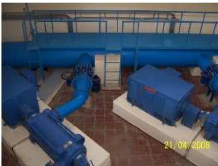
Station de pompage du station de traitement de sikkek (Tlemcen)
