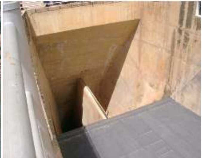
Vanne de sectionnement de barrage béni bahdel (Tlemcen)
