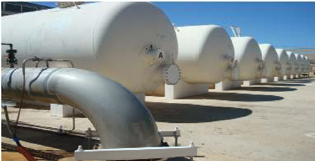
Les filtres a sable de la station de déméralisation (Oran)
