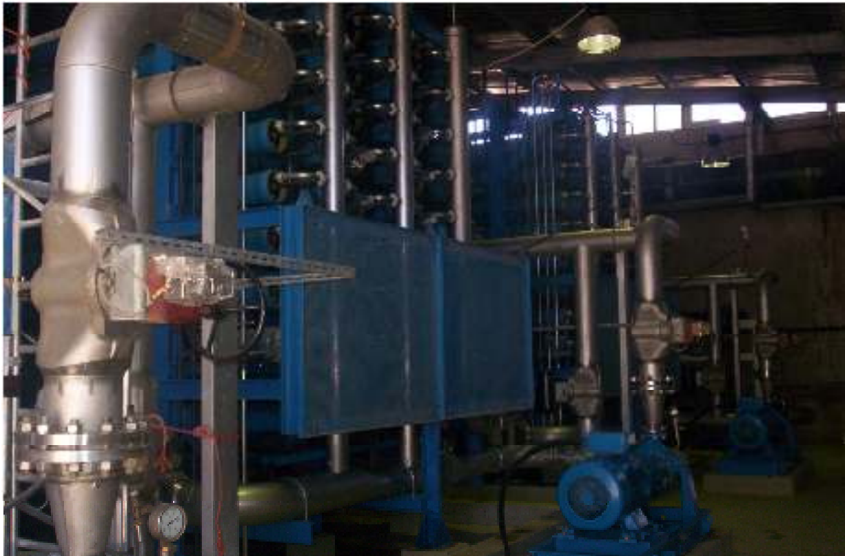
Les membranes de la station de déméralisation (Oran)
