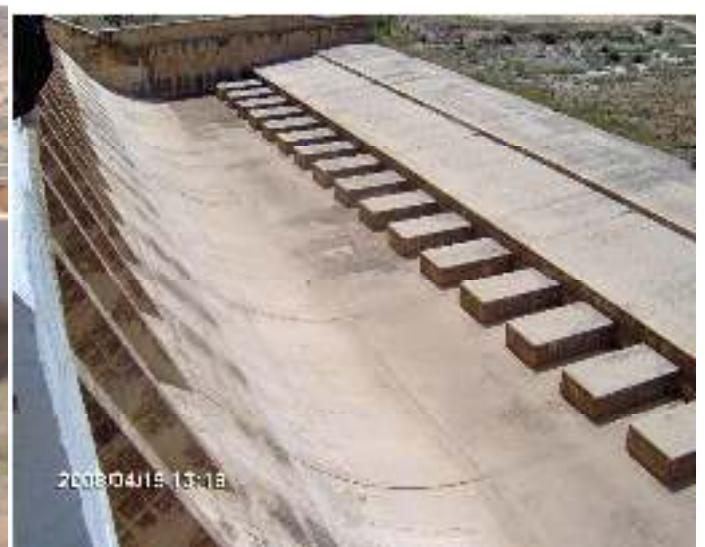
Bassin de dissipation de barrage béni bahdel (Tlemcen)
