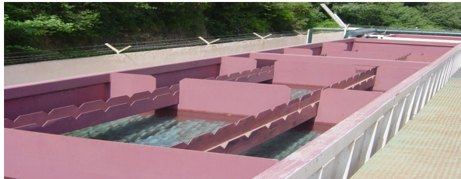
Figure 01 : premier module traitant un débit de 30l/s
