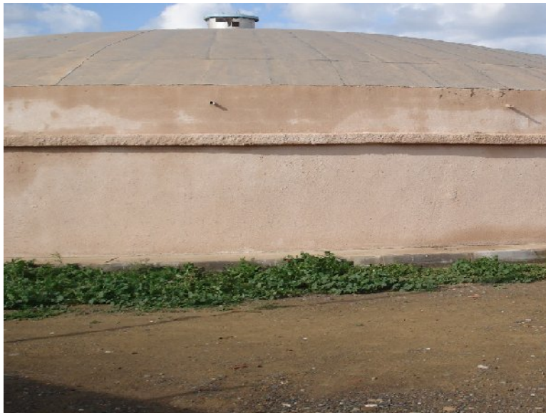
Figure N°V.6: Réservoir de 1000m^3 dans la commune de Damous.
