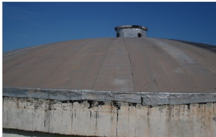
Figure N°V.2: Fuite à travers les parois du réservoir de 625m 3 de Gouraya (Berbouk)
