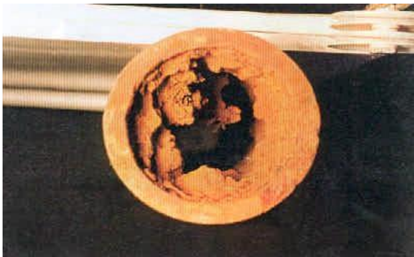
Figure VII-1: Corrosion interne dans une conduite.
