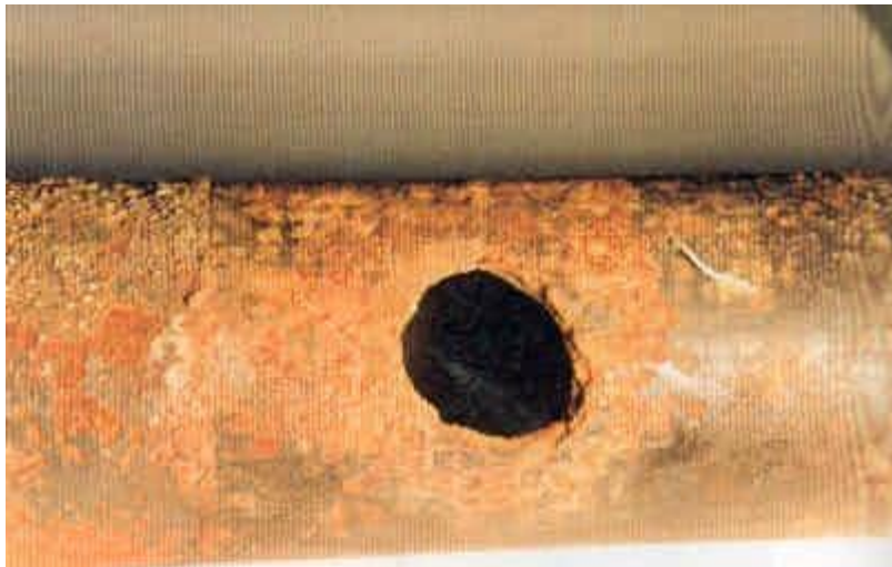
Figure VII-2: Corrosion externe dans une conduite.
