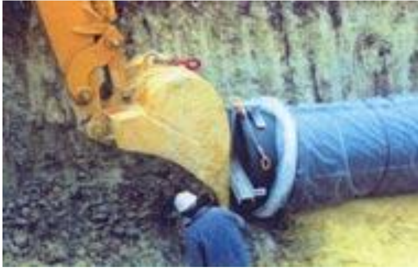
Figure VIII-1-c: Pose de conduites dans un terrain agressif.
