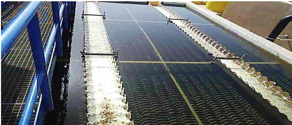
Figure VI-3 : Le décanteur de la station de B-I
