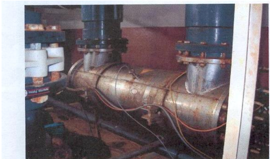
Figure VI-6: L'appareil à (UV) de la station de B-I
