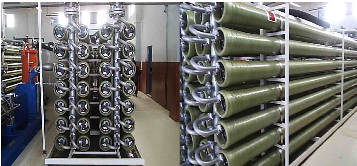
Figure VI-10 : Les tubes de pressions de l'osmoseur de la station.
