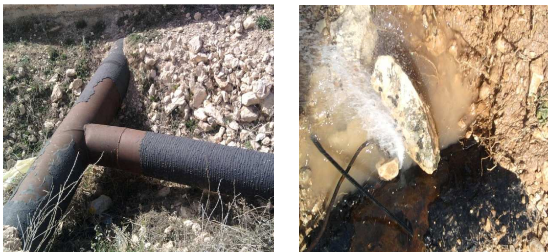
Figure II-12: Conduites du réseau de distribution en mauvaise état.
