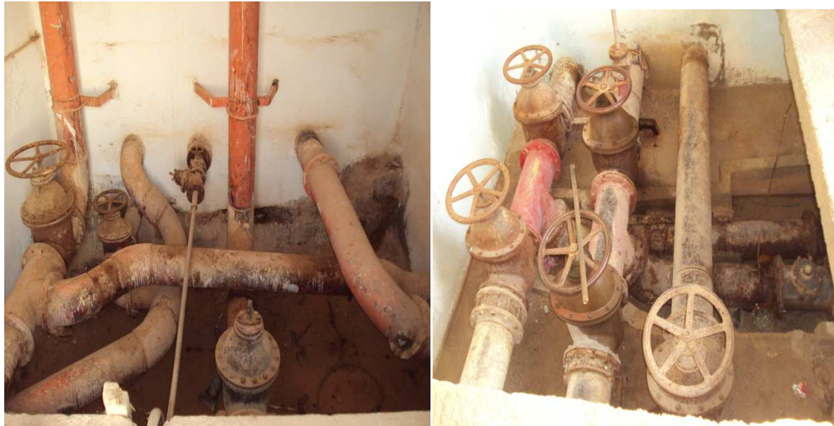
Figure II-8: Chambre de vannes des Cuves jumelés R2+R3 (2X1000) m 3 .
