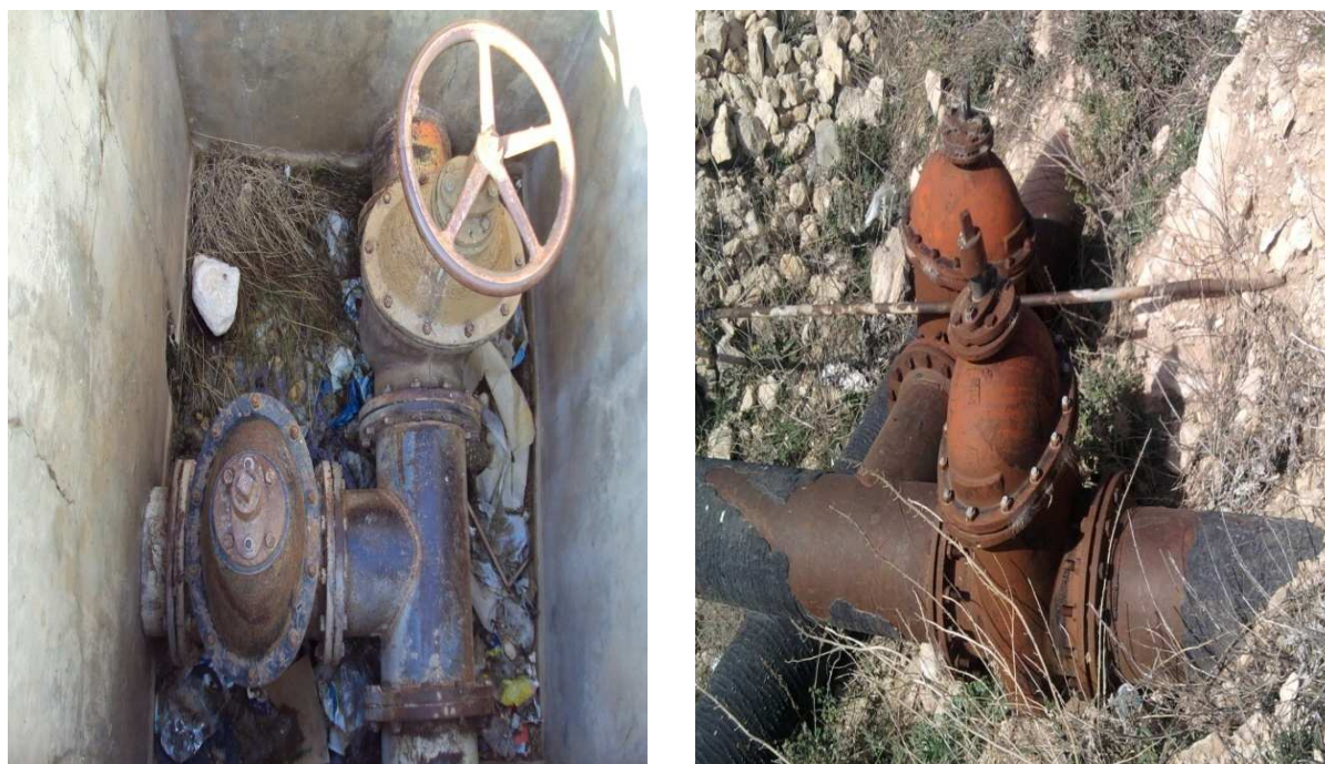
Figure II-11: Regards de vannes en mauvais état.
