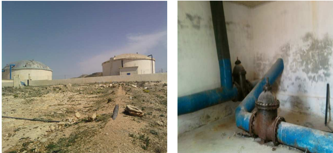
Figure II-9: Cuves jumelés R5 et R6 (2X2000 m 3 )
