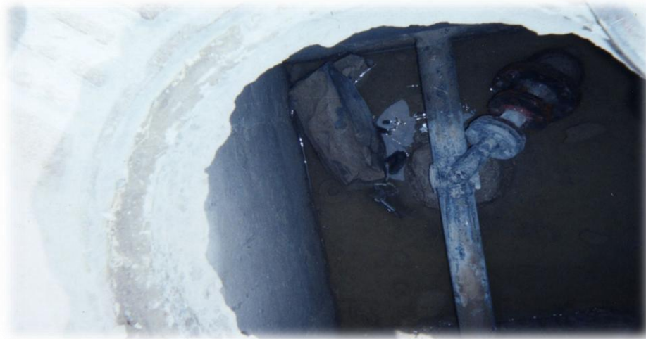
Figure I.12 : Ventouse en bon état posée sur la conduite d'adduction \varphi 90 en PEHD mais il faut changer la colonne montante.
