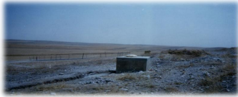
Figure I.10 : Regard de ventouse en bon état sur la conduite d'adduction \phi 150 en amiante ciment.
