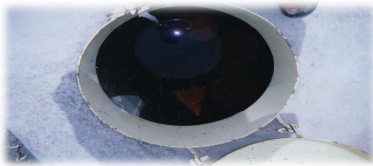
Figure I.9 : Ventouse immergée posée sur la conduite d'adduction φ150 en Amiante ciment. Ventouse dégradée (corrosion avancée)
