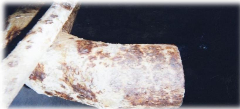
Figure I.6 : Dégradation de la conduite d'arrivée à l'intérieur Du réservoir 1000 m 3 à cause de contact (acier + eau).
