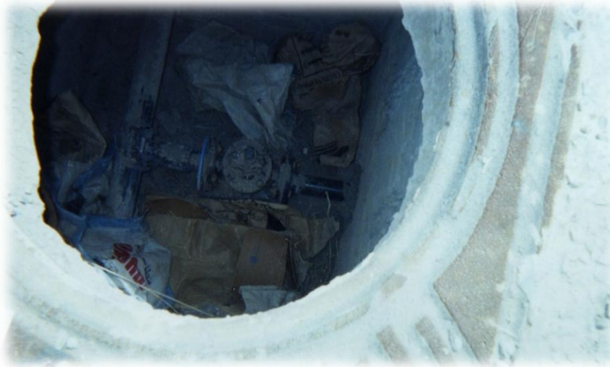
Figure I.11 : Vidange en bon état posée sur la conduite d'adduction \varphi 90 en PEHD Tampon en fonte volé. Déchet à l'intérieur du regard.
