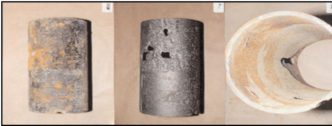
Figure 3.1 : Corrosion des conduites métallique
