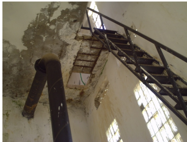
Figure III.5.12: Conduite du trop plein et l'échelle d'accès.
