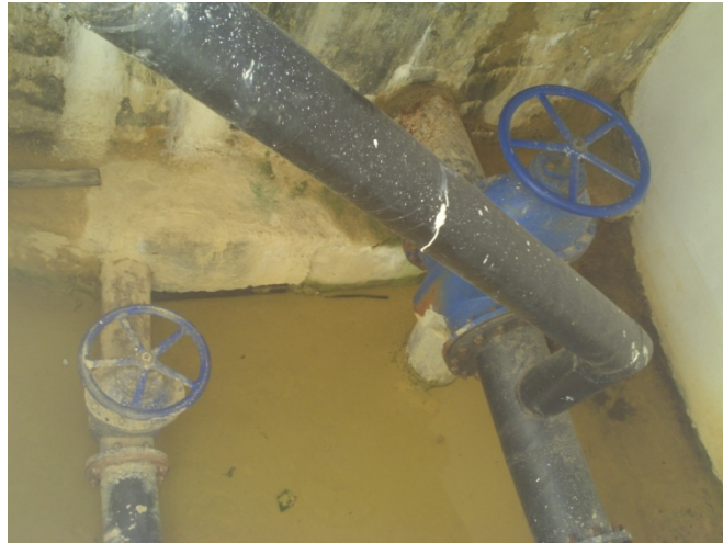
Figure III.5.6: Conduite d'arrivée et du trop plein.
