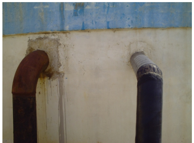
Figure III.5.6: Conduite d'arrivée et du trop plein.
