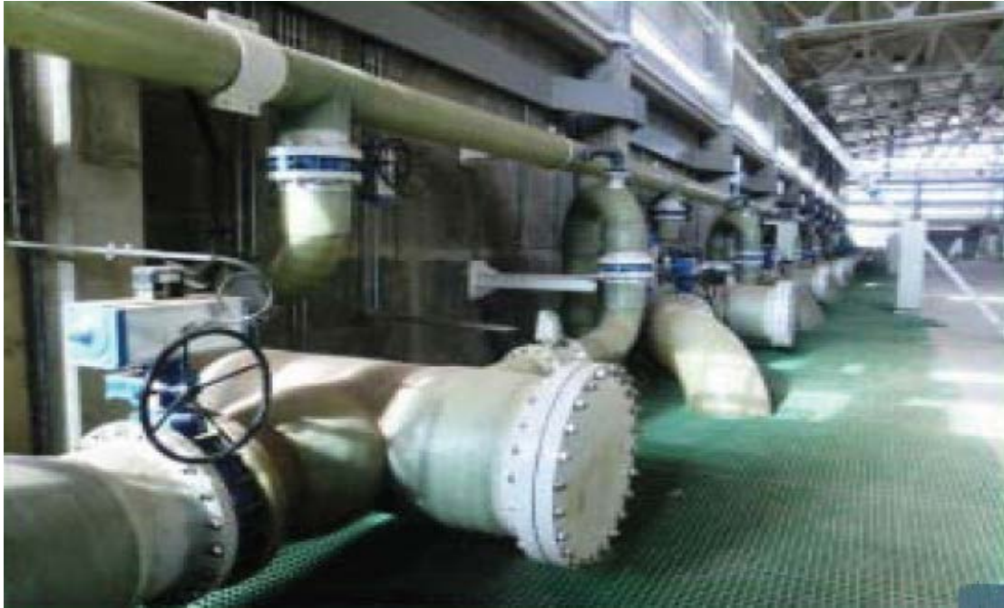
Figure I.5 : Station de dessalement de Fouka.
