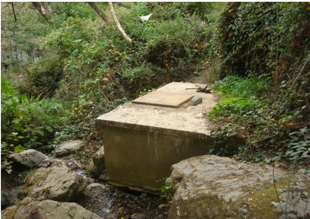
Figure II.3 : Bêche de captage source Oued Bourebou
