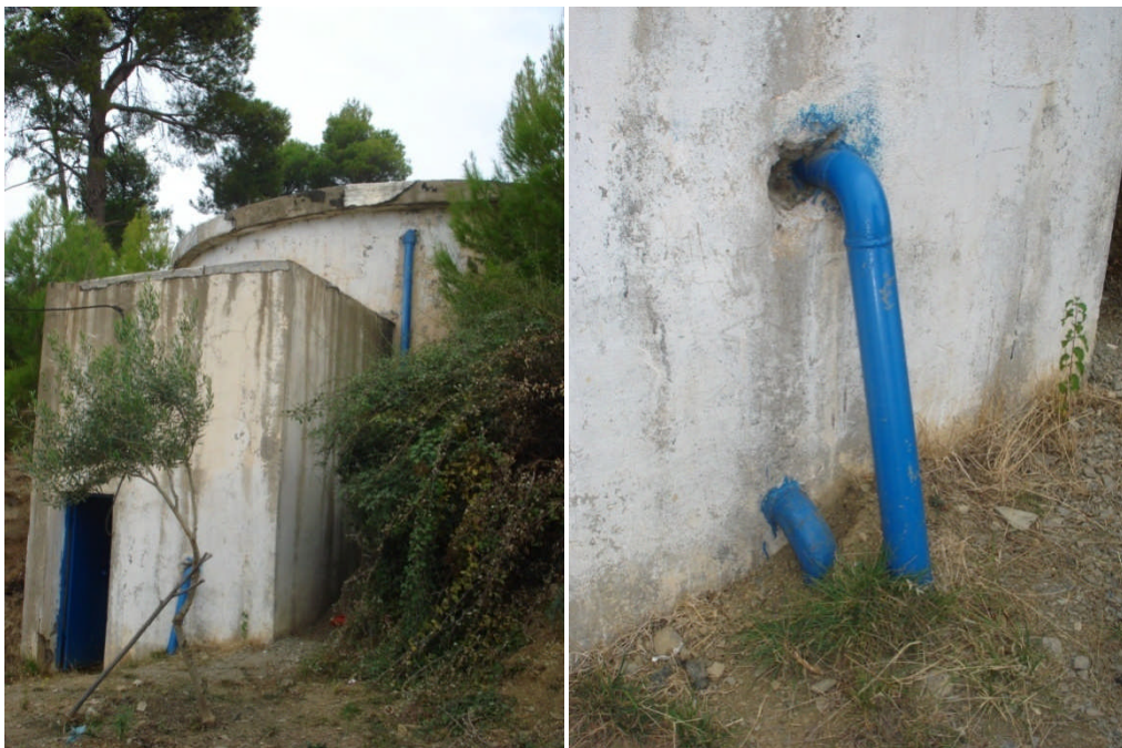
Figure II.10 : Réservoir 250m 3 de Beni Ali
