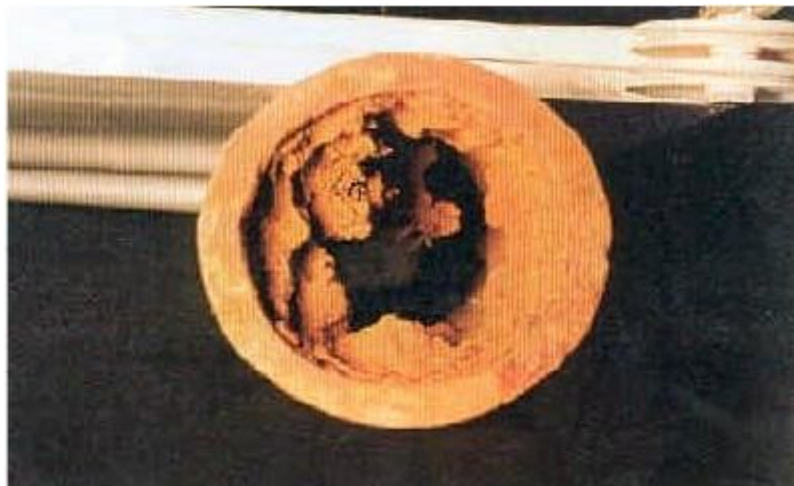
Figure V.2.: Corrosion interne dans une conduite
