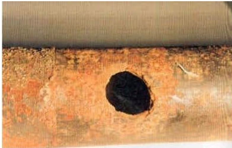
Figure V.3.: Corrosion externe dans une conduite
