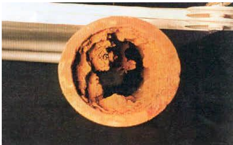
Figure VII-4 : Corrosion interne dans une conduite
