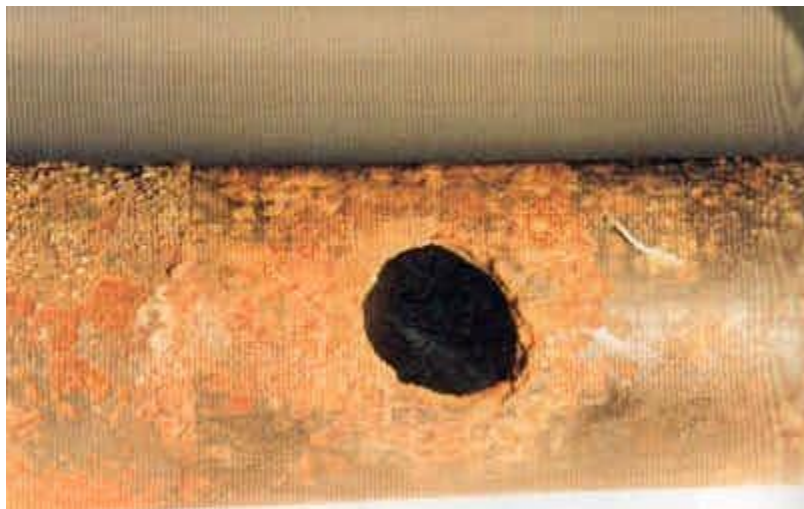
Figure VII-5: Corrosion externe dans une conduite
