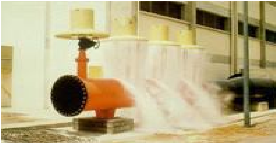
Figure IV.3 : Soupapes de décharge en fonctionnement [photo KSB]
