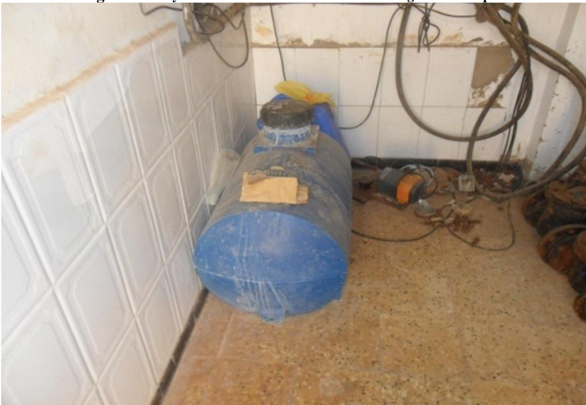
Figure N°4 : Système de Javellisation à rénover Forage Khmis El Kadim
