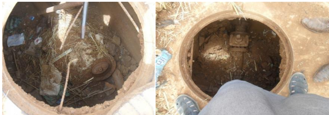
FigureIV-7 : regard en mauvais état au niveau de réseau
