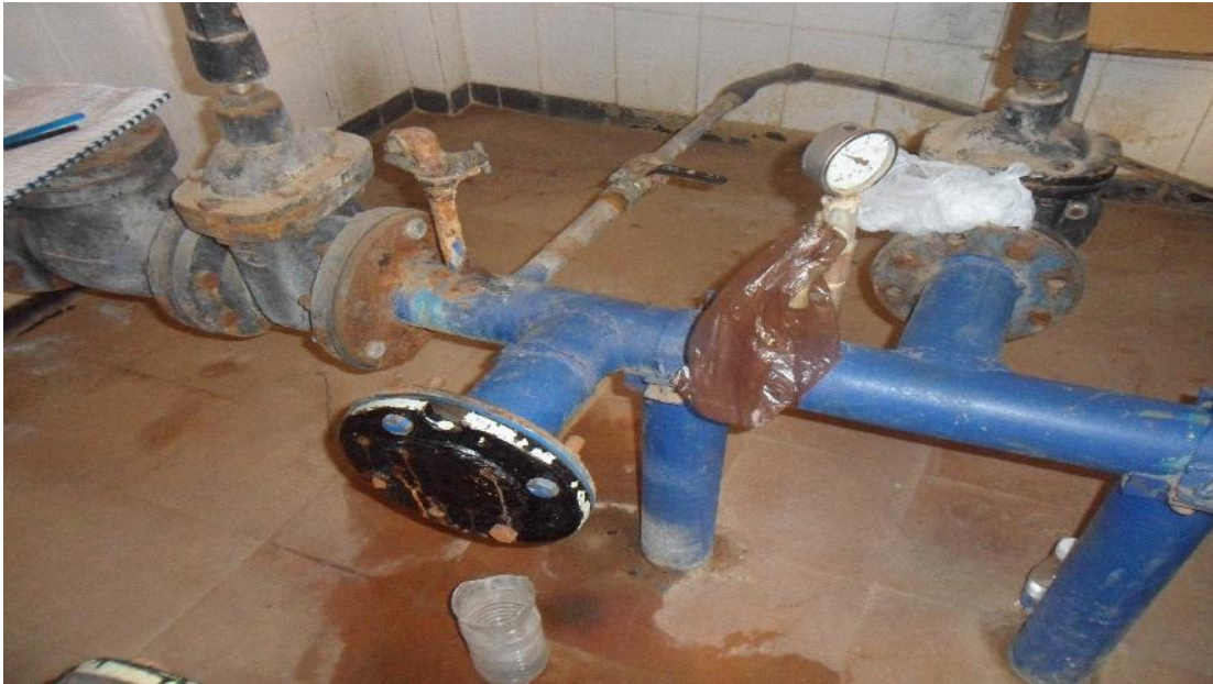
Figure N°1 : Etat actuel des vannes au niveau de forage centre 200m 3
