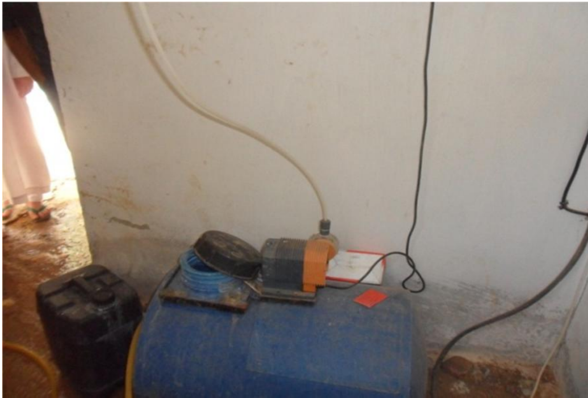
Figure N°3 : Système de Javellisation à rénover : Forage de la Mosquée
