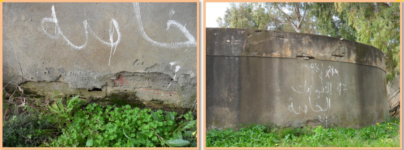
Figure 1-3 : Etat du réservoir R1
