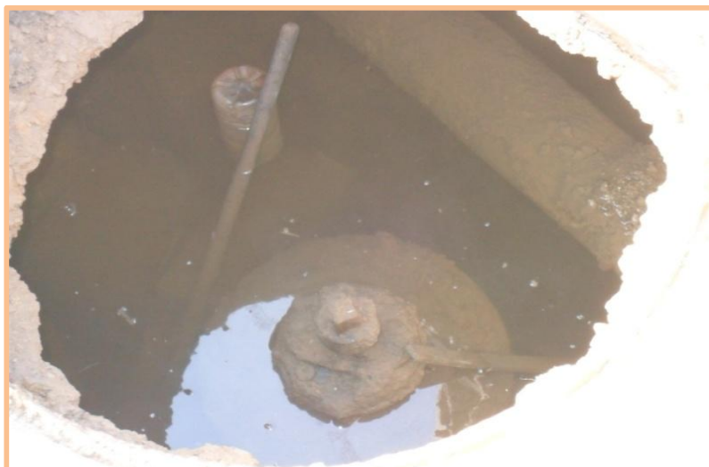
Figure 1-5 : Vanne sur le réseau principal 150 AC
