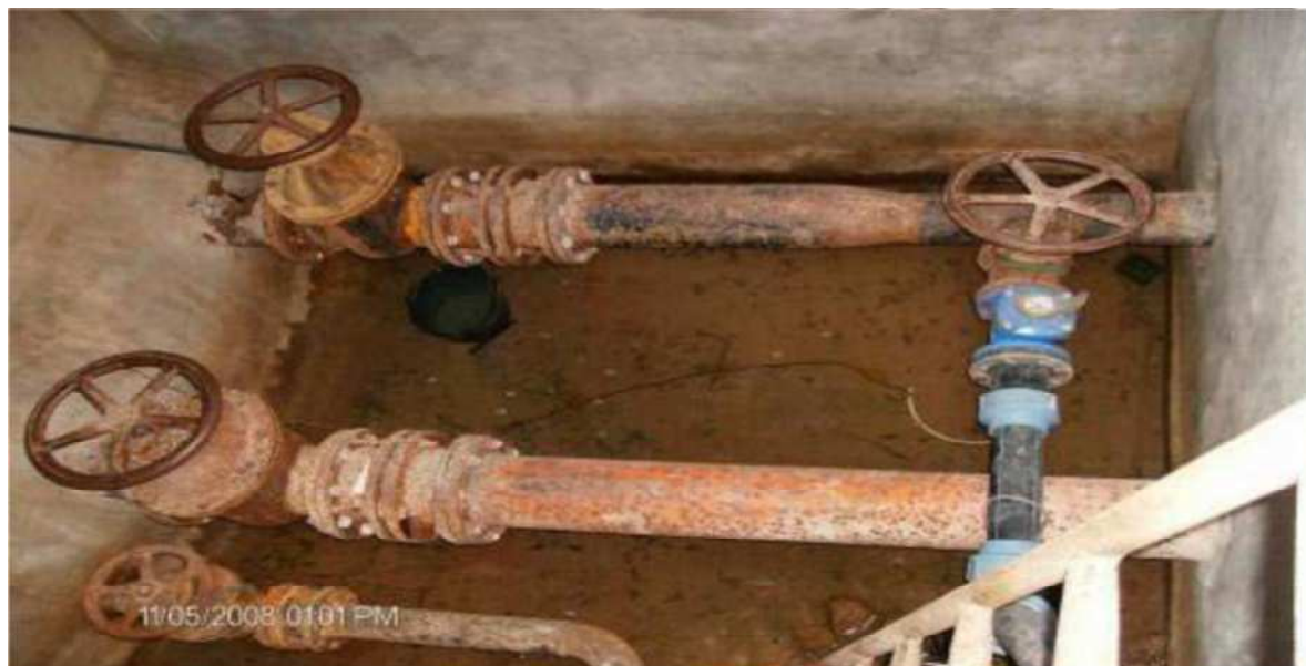
Figure III .2 : Réservoir existants 500m 3 - Ahmar El Ain (regard de vannes)
