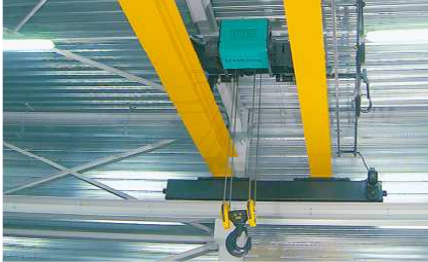
Figure V.11 Pont roulant motorisé posé sur deux poutres
