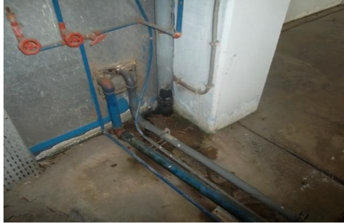
Figure III- 30 : Système d'évacuation des toitures détériorées
