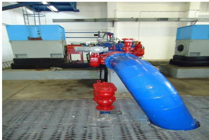
Figure III.3 : Moteur électrique de marque rade koncar
