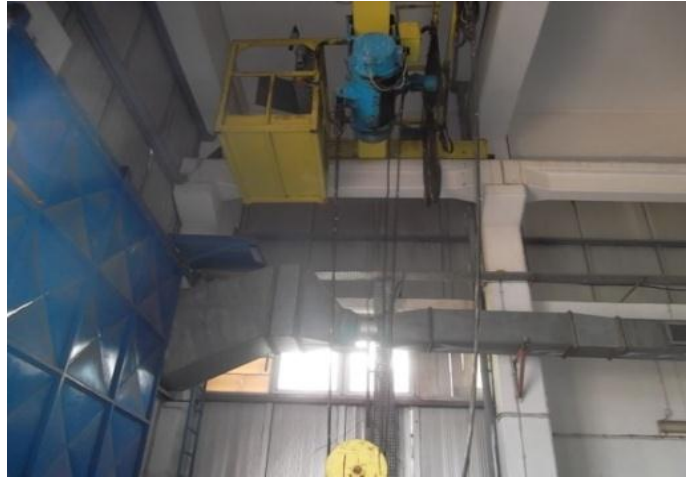
Figure III-4 : Pont roulant existant dans la station de pompage de TAFOURAH
