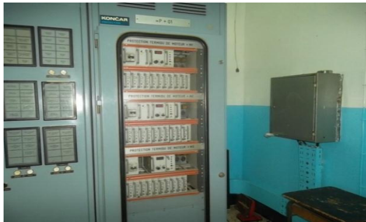
Figure III- 19 : Armoire de protection thermique
