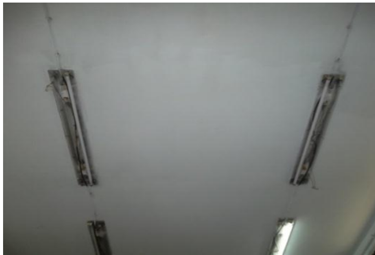
Figure III-20 : Eclairage existant dans la station de pompage de Tafourah
