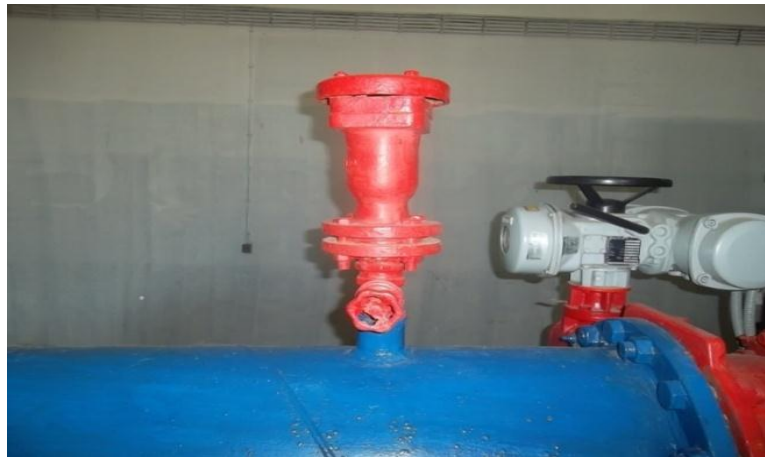
Figure III-11 : Ventouse existante sur le refoulement
