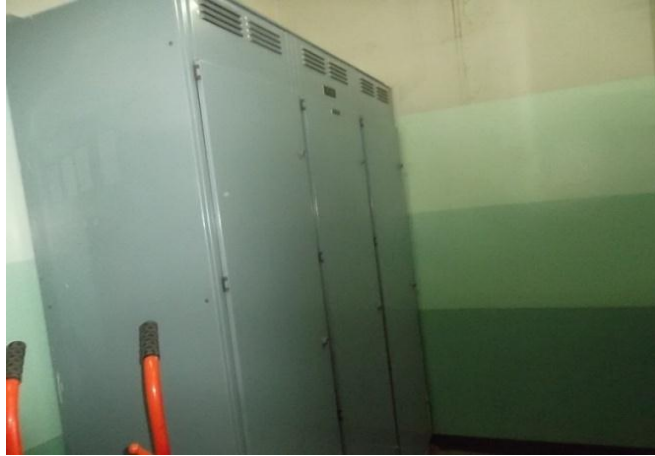
Figure III- 17 : Armoire des accumulateurs
