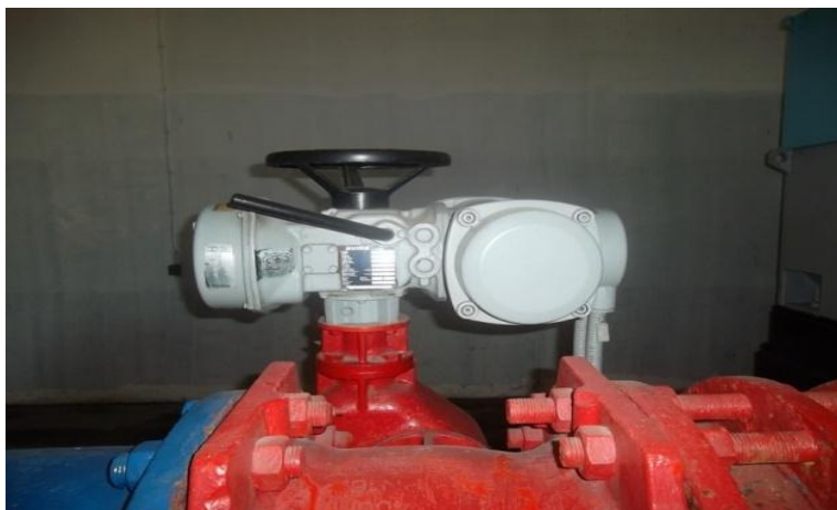
Figure III- 10 : Vanne de sectionnement
