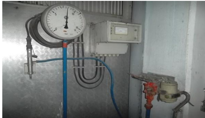
Figure III-22 : Manomètre de refoulement collectif
