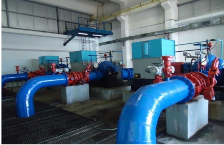
Figure III.1 : Salle des machines de la station de pompage de TAFOURAH
