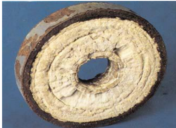
Figure I.5 : Canalisation bouchée avec incrustation calcaire
