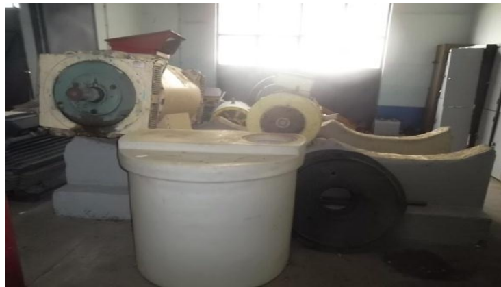
Figure III- 28 : Salle de chloration détériorée
