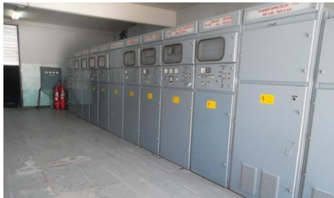
Figure III-15 : Armoire de commutation
