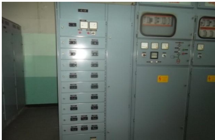
Figure III-16 : Armoire des redresseurs
