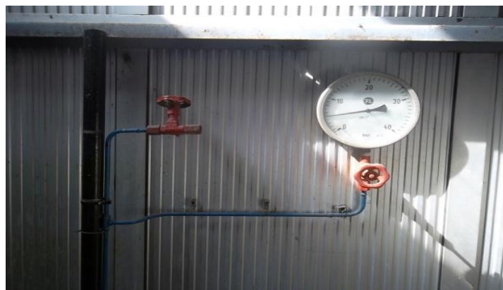
Figure III-23 : Manomètre d'aspiration collective
