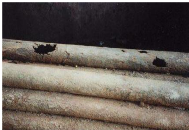
Figure I.6 : Conduite détériorée à cause d'une eau agressive
