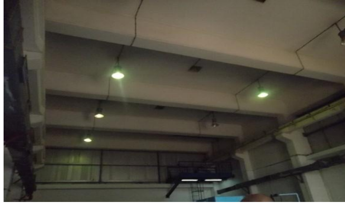
Figure III.5 : Système de ventilation dans la station de pompage de tafourah
