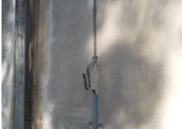
Figure III-21 : Système de parafoudre existant dans la station de Tafourah
