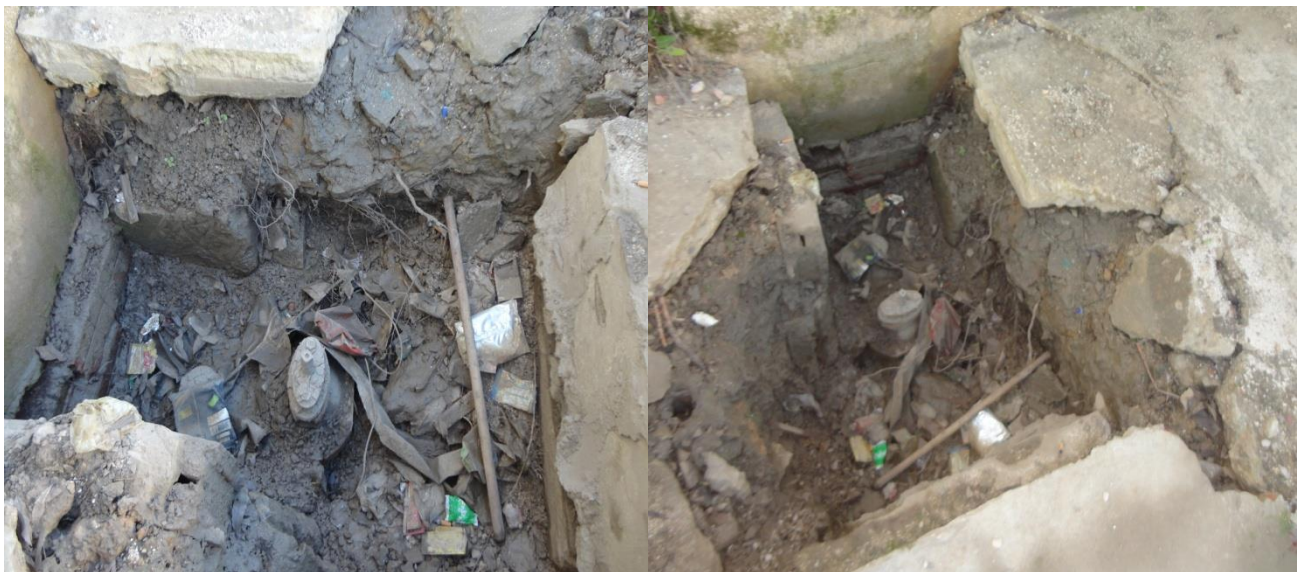
Figura III.34: Regard de sectionnement.
