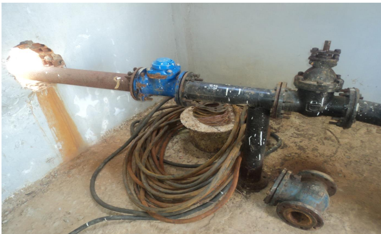
Figure III.22: L'état des déférents accessoires dans la chambre de commande du forage U4.
