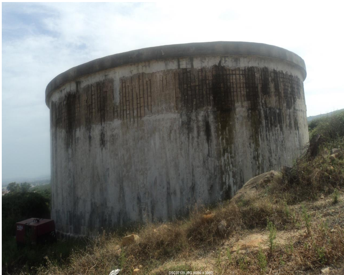
Figure III.38: Ferrailage visible au niveau de la paroi.
