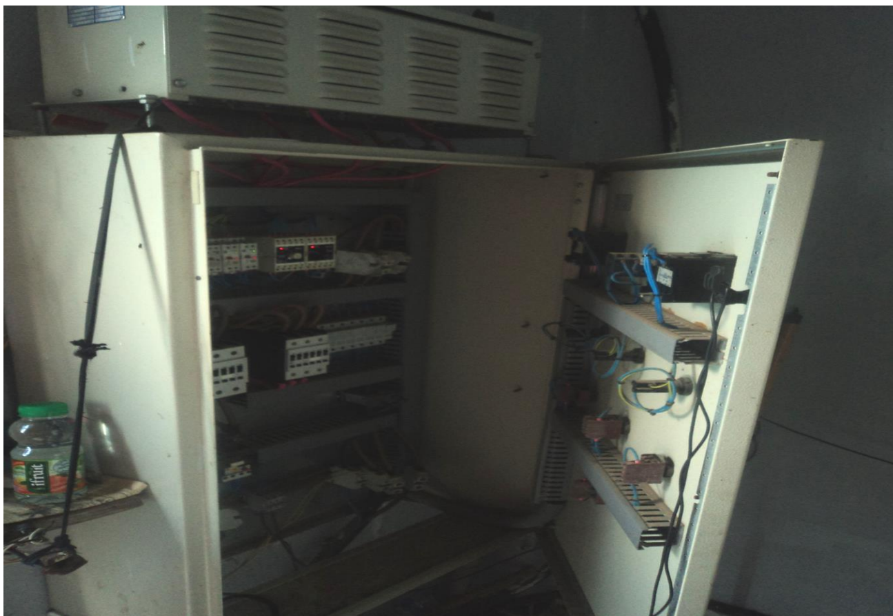
Figure III.25: L'état actuel de l'armoire de commande du forage U5.
