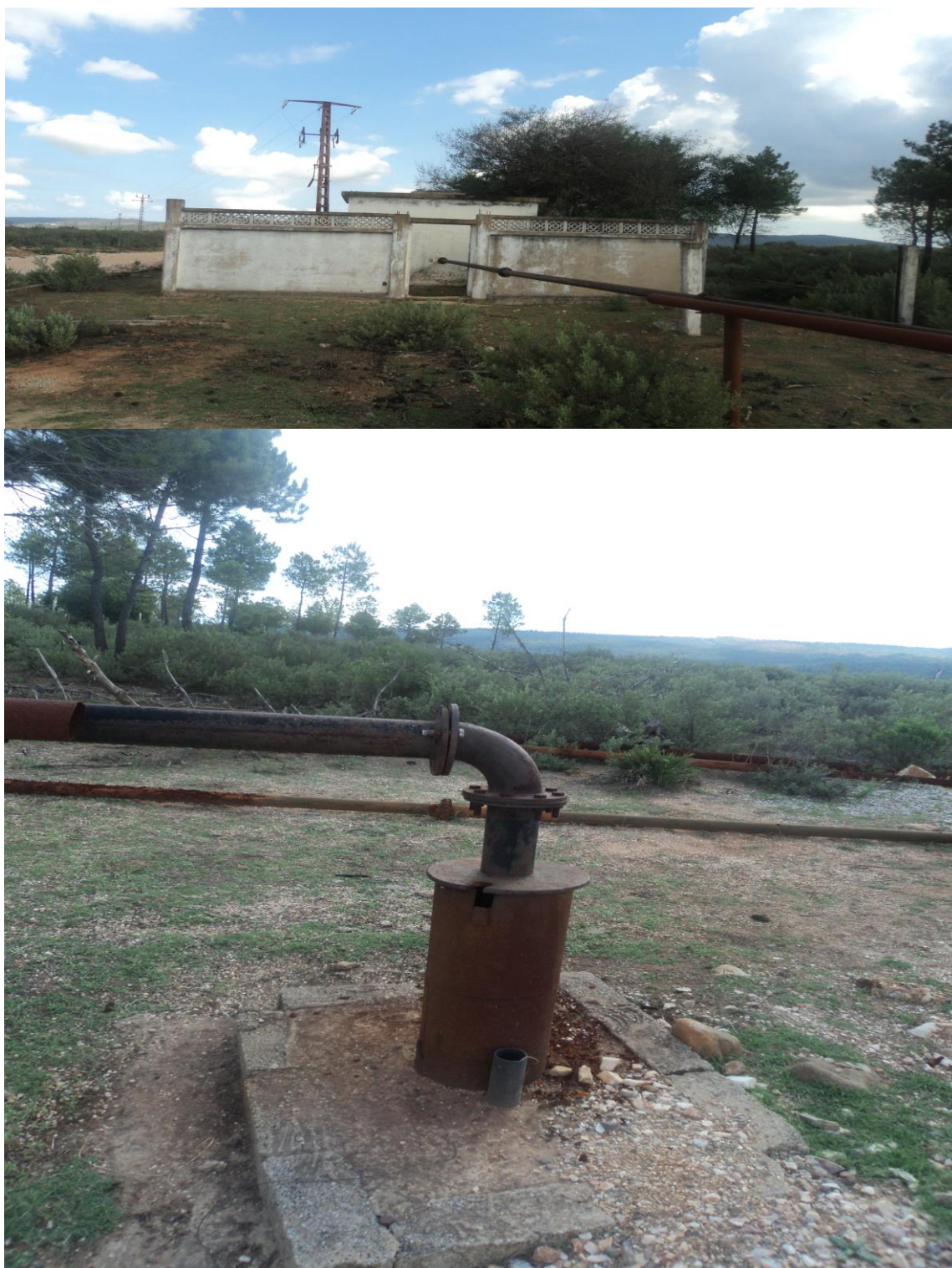
Figure III.14 : Etat actuel du forage U1.
