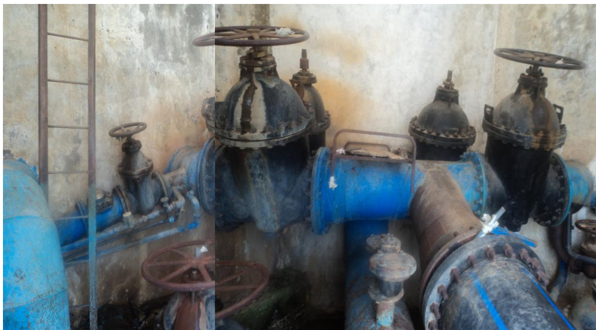
Figure III.39 L'ensemble des équipements des deux réservoirs.
