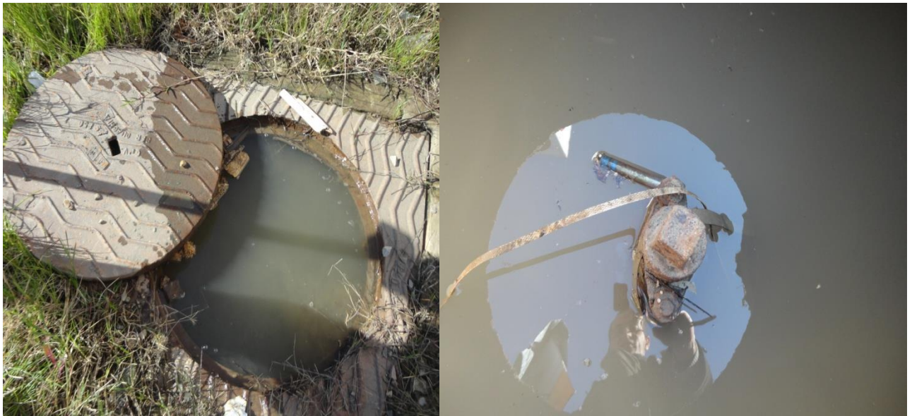
Figure III.35 : Regard de sectionnement.
