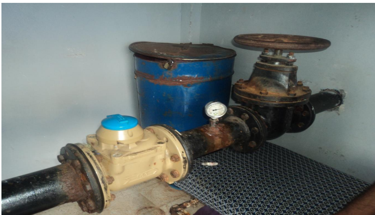
Figure III.26: Etat des différents accessoires dans la chambre de commande du forage U5
