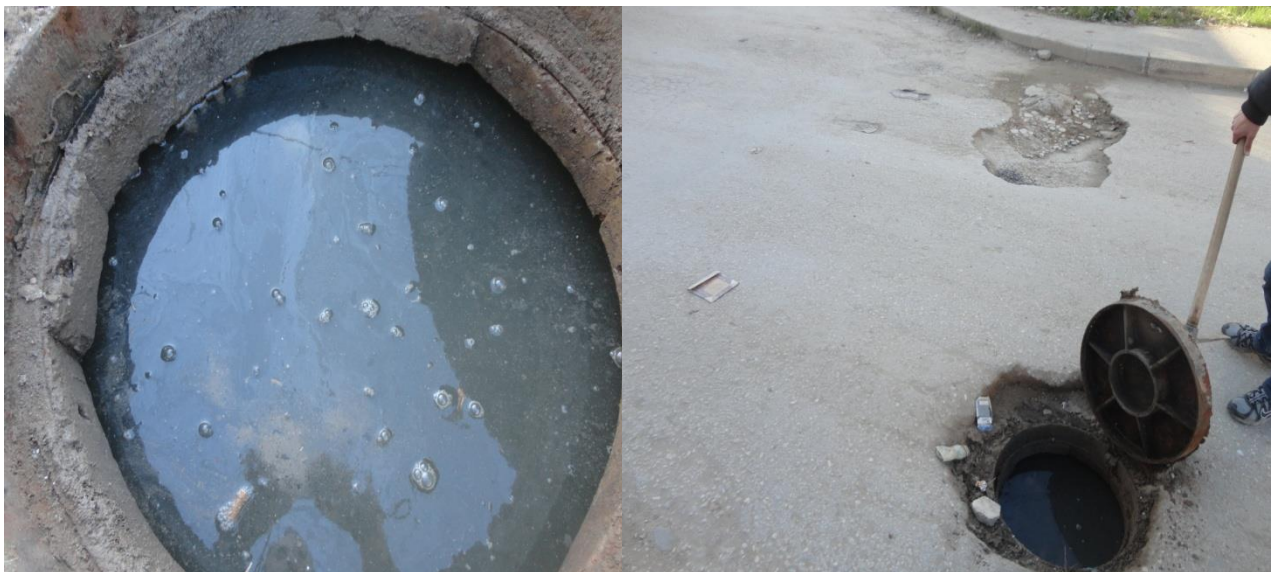
Figure III.36: regard de sectionnement.
