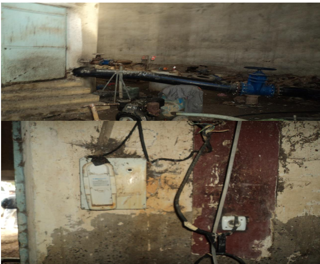
Figure III.43: Etat actuel de l'ensemble des équipements du réservoir 750 m 3 .
