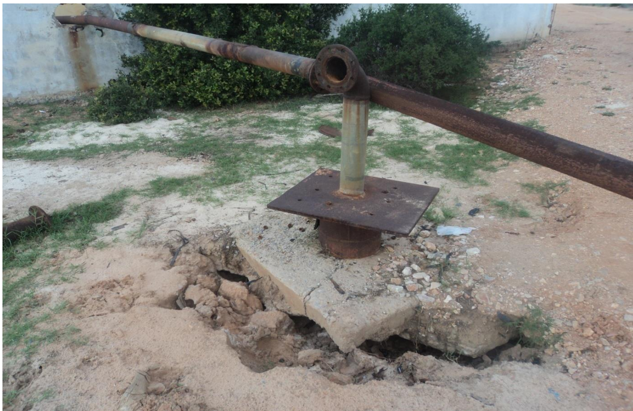
Figure III.21: Etat actuel du forage U4.
