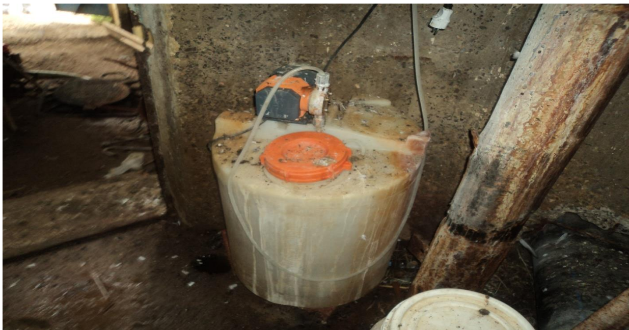
Figure III.42: La pompe doseuse du chlore dans la chambre de manœuvre.
