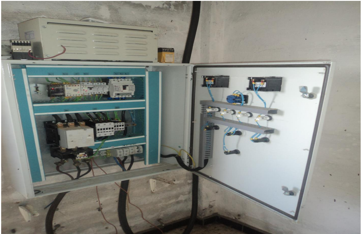
Figure III.29: Etat des différents accessoires dans la chambre de commande du forage U6.
