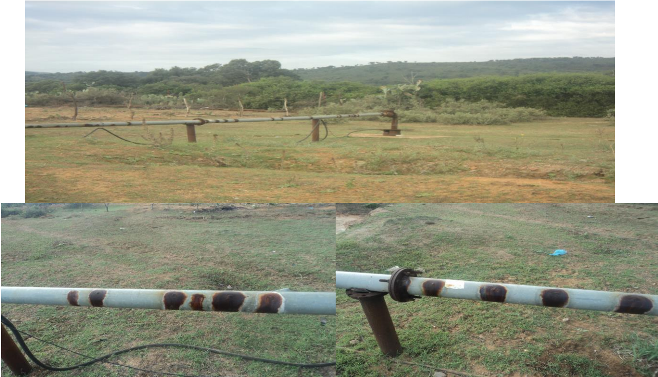
Figure III.4: Etat actuel de la conduite de refoulement du forage F1.
