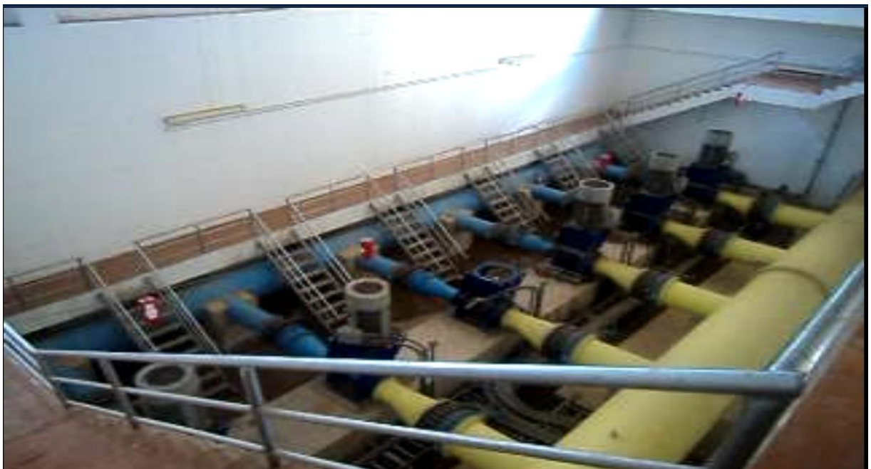
Figure III.31 : Vue sur les six pompes de la station.
