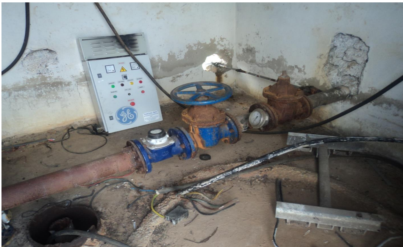
Figure III.17 : l'état des déférents accessoires dans la chambre de commande du forage U2
