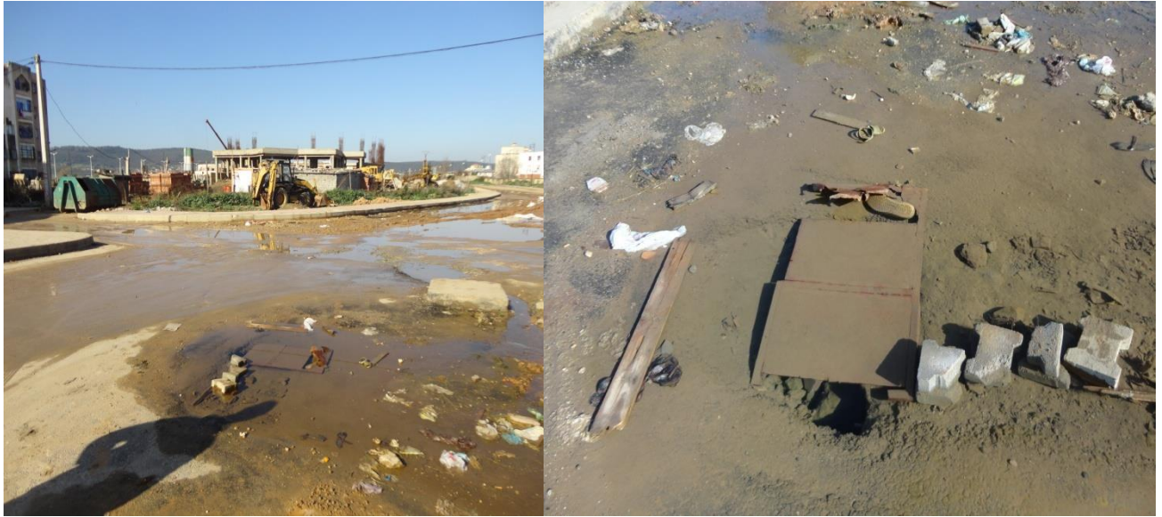
Figure III.33: Fuite au niveau de la vanne implantée sur la conduite de distribution.
