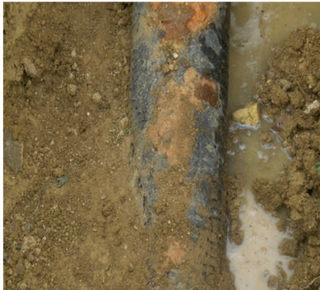
Figure 3-3: Conduites du réseau de distribution en mauvaise état.
