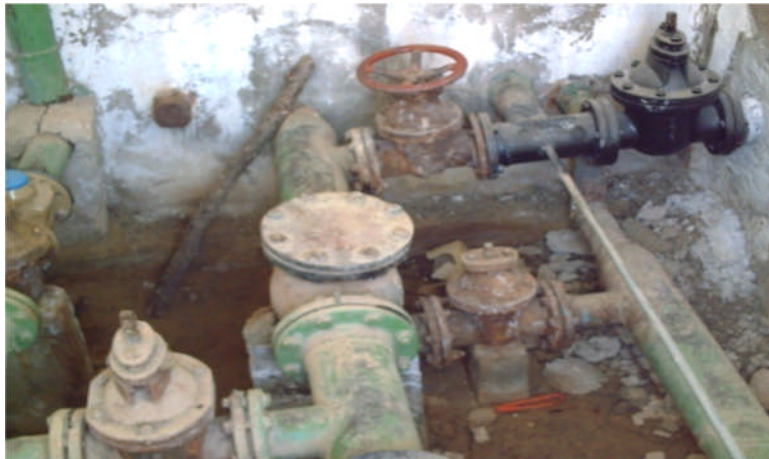
Figure 3-1 : Chambre de vannes du réservoir de volume 150 \text{ m}^3
