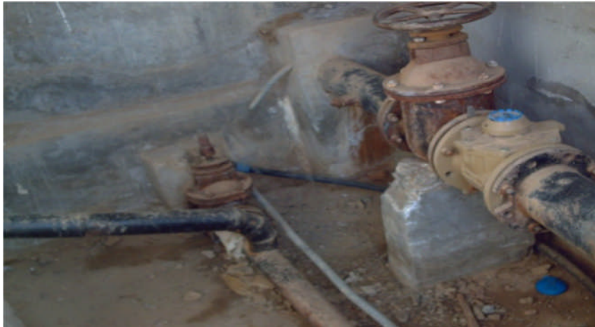
Figure 3-2 : Chambre de vannes du réservoir de volume 300m 3
