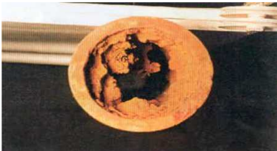
Figure VI-4: Corrosion interne dans une conduite.
