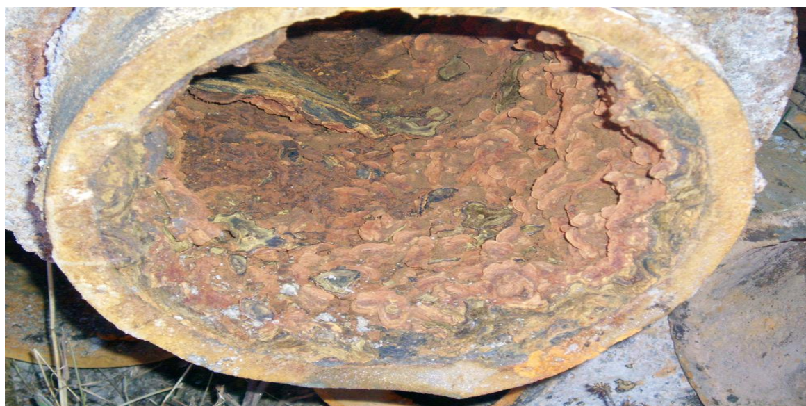
Figure VII-1 : Corrosion interne dans une conduite.
