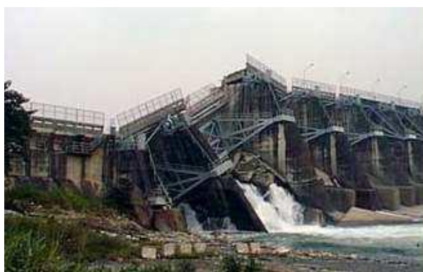
Figure 1.10 : Barrage de Shih-Kang après le séisme Chi Chi (Taïwan). Rupture au droit de la faille.
