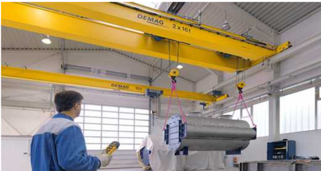
Figure V.8. Le pont roulant
