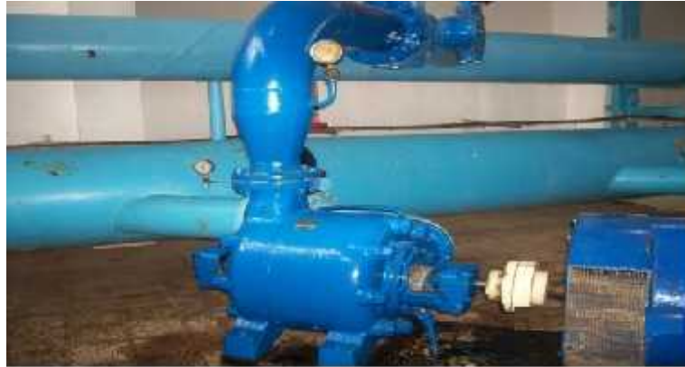
Figure V.6 : Pompe et moteur, divergent, coude, manomètre, conduites de refoulement individuel et collectif, clapet anti-retour
