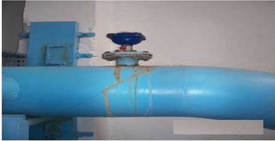
Figure V.7 : Conduite de refoulement et ventouse
