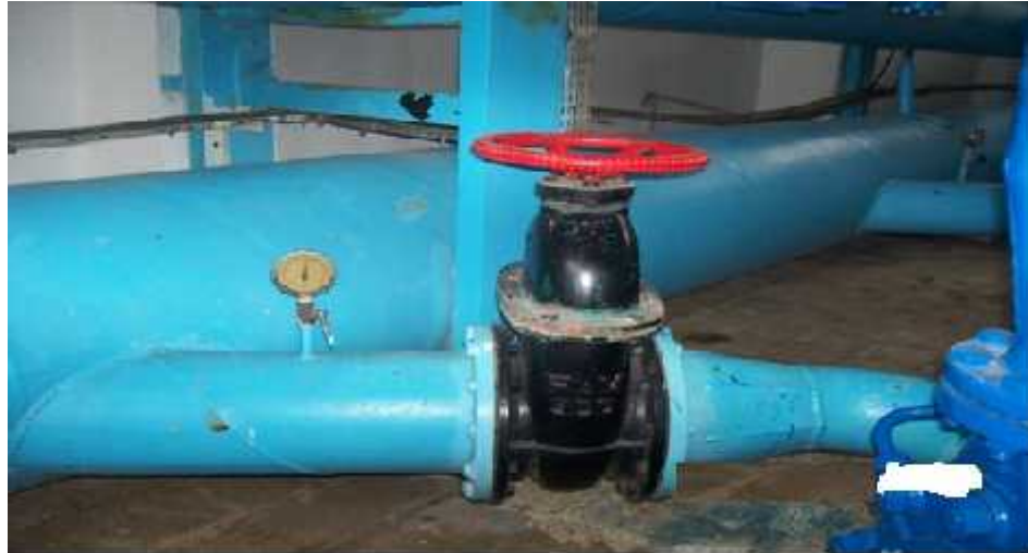
Figure V.5: Vanne d'aspiration, conduites d'aspiration collective et individuelle convergent, coude et manomètre
