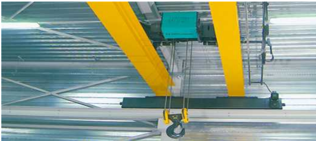
Figure V.7 : Pont roulant motorisé posé sur deux poutres.
