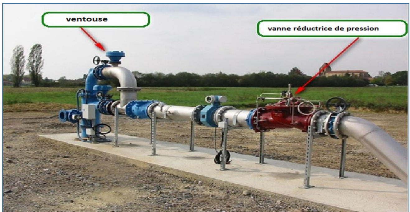
Figure III.10 : Installations de la vanne de réduction de pression aval dans un réseau de distribution
