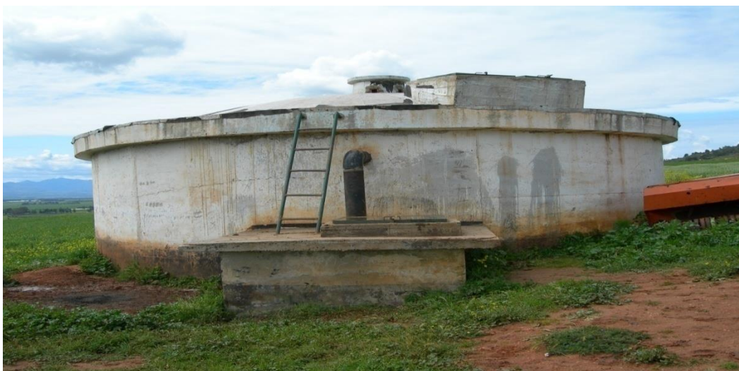
Figure II-10: Réservoir de 250 m 3 (Krèz ).
