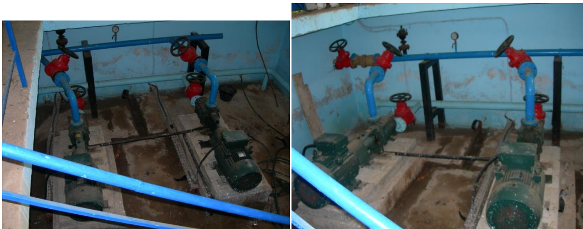
Figure II-7: Station de pompage du chef lieu.
