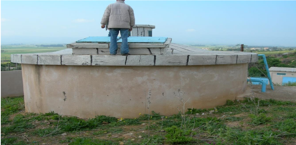
Figure II-11: Réservoir de 250 m 3 (Boucetta).
