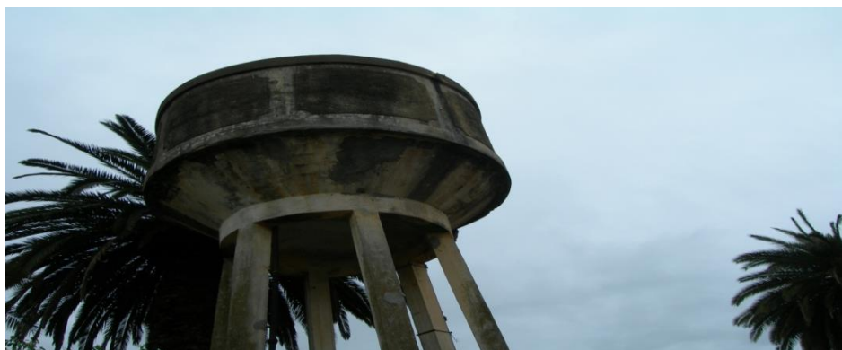
Figure II-14: Réservoir surélevée 25 m 3 (Douar Lahouel).
