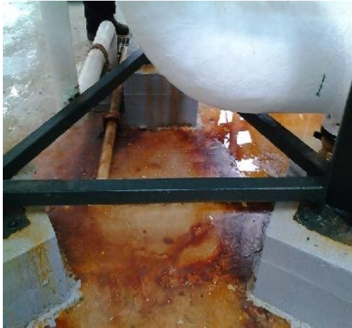
Figure V-5 : au niveau de la microfiltration.
