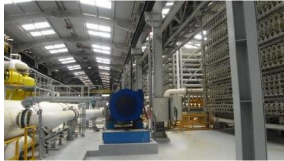
Figure IV-7 : Unité d'Osmose Inversée[19]
