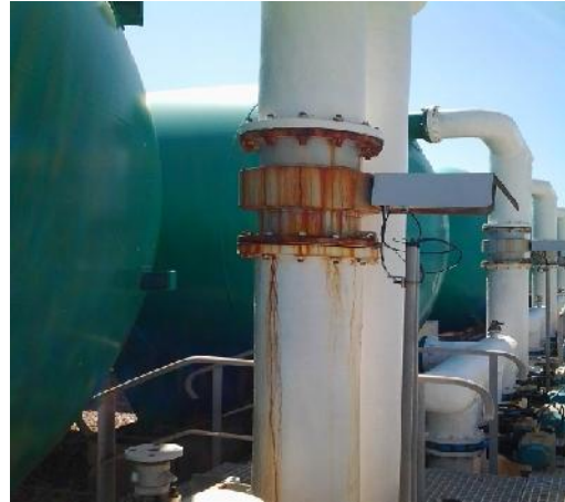
Figure V-6 : au niveau de prétraitement.
