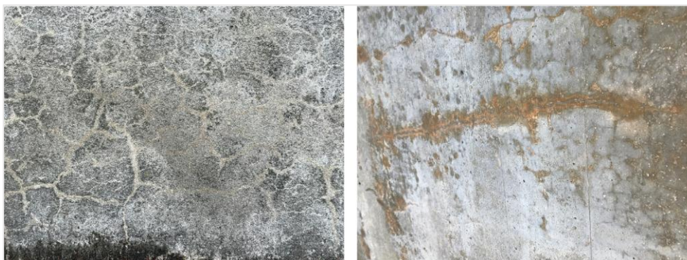
Figure I.13 : Propagation de fissures due à l'alkali agrégat réaction dans deux différents barrages en béton (Figueira et al. , 2019)
