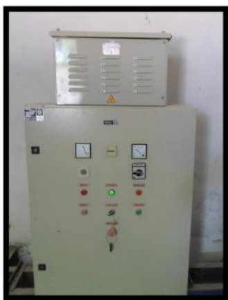
Figure-II-12. armoire de commandes de la Station de pompage 3.
