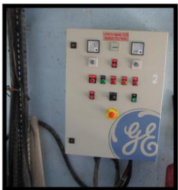
Figure-II-7.armoire de commandes de la Station de pompage 2.
