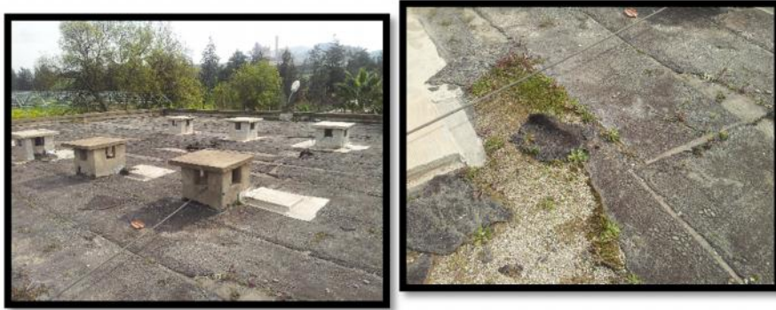
Figure-II-10. Etat de la toiture de la station de pompage 3.
