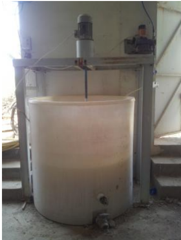
Figure-II-20. Réservoir de chlore du réservoir 750m 3 .
