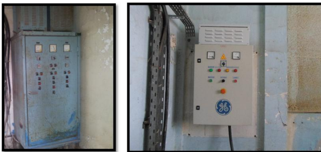
Figure-II-4.armoires de commandes de la Station de pompage 1.
