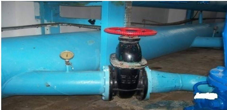
Figure V-11 : Vanne d'aspiration, conduites d'aspiration collective et individuelle convergent, coude et manomètre.
