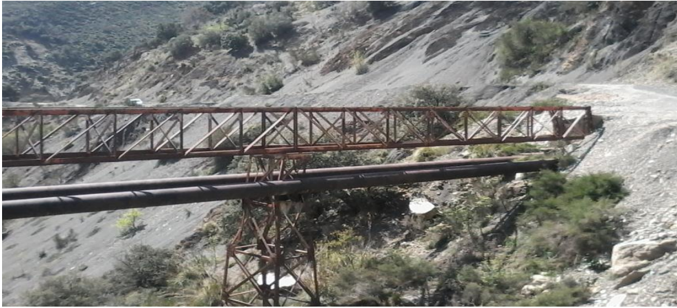
Figure I-11: Conduite en acier (2015).
