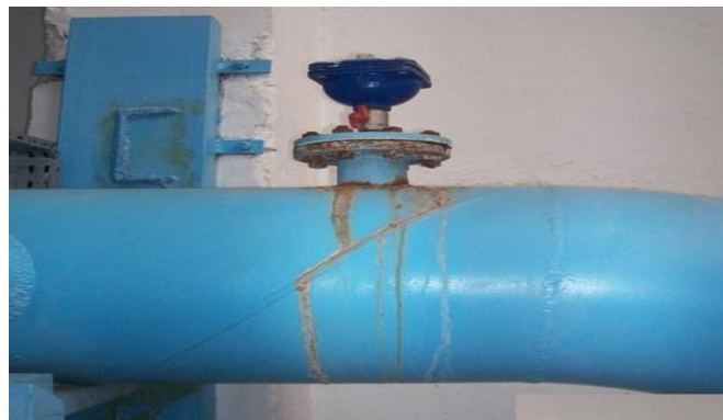
Figure V-13 : Conduite de refoulement et ventouse.
