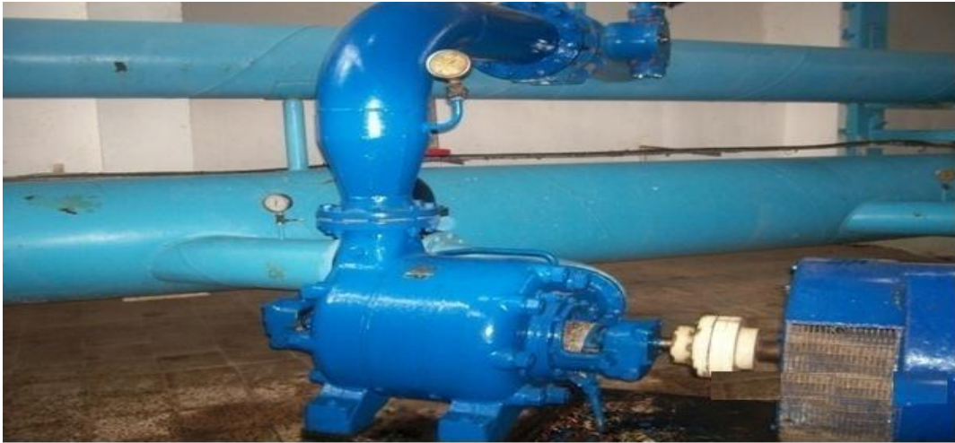
Figure V-12 : Pompe et moteur, divergent, coude, manomètre, conduites de refoulement individuel et collectif, clapet anti-retour.
