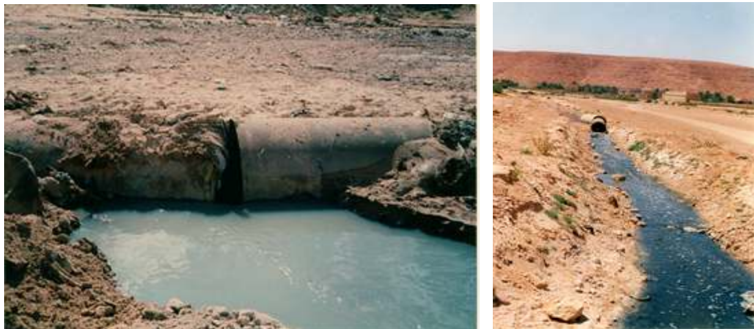
Figure IV.18: Disjoints des tuyaux et rejets au plein d'Oued -1997 (BG; 2000)
