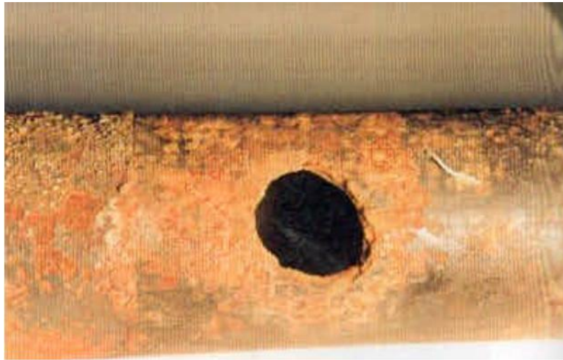
Figure VI-5 : Corrosion externe dans une conduite
