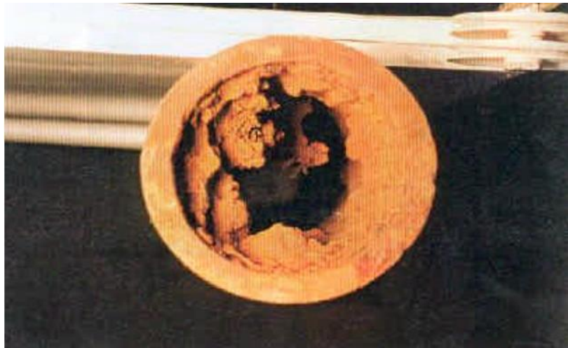
Figure VI-4 : Corrosion interne dans une conduite
