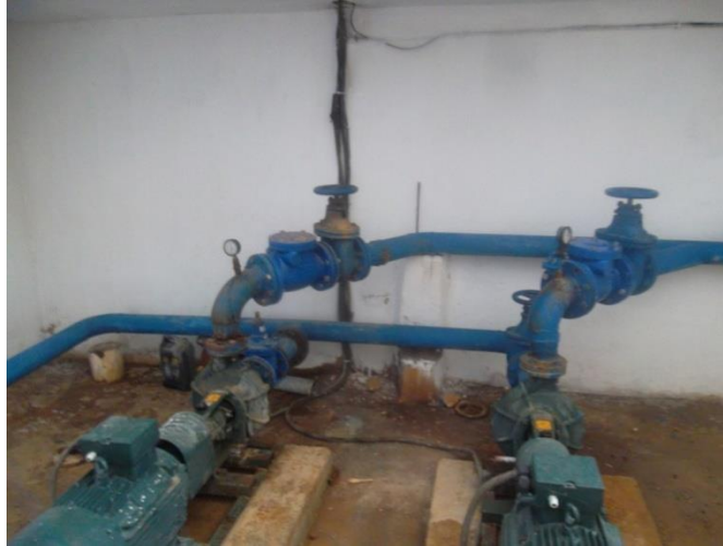
Figure 12 : Photo de la station de pompage Plateau Sud
