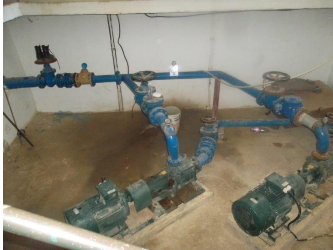
Figure 15 : Photo de la station de pompage Oued El Hammam
