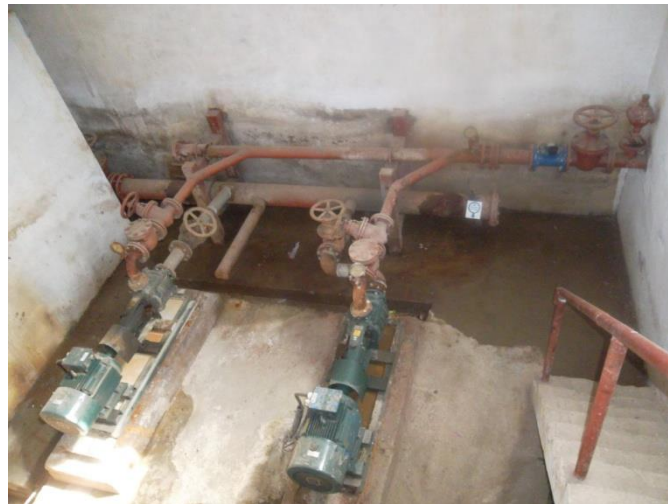
Figure 14 : Fig III.1. Photo de la station de pompage Oudai Ibrahim
