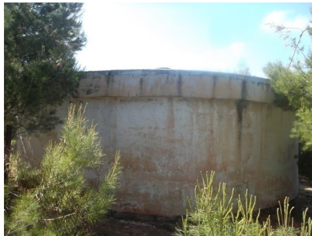
Figure 27 : Photo du réservoir Bordj El Ghoula
