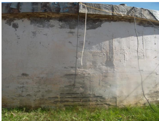
Figure 22 : Photo illustrant l'éclatement du béton du réservoir
