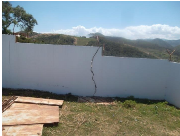
Figure 25 : Photo illustrant la clôture fissurée du site
