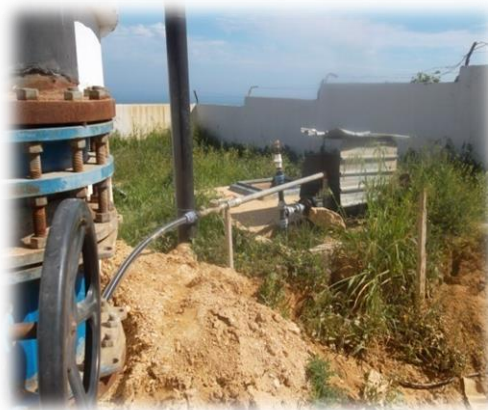
Figure 7 : Photo du forage Bakora
