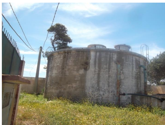
Figure 28 : Photo du réservoir Plateau Sud
