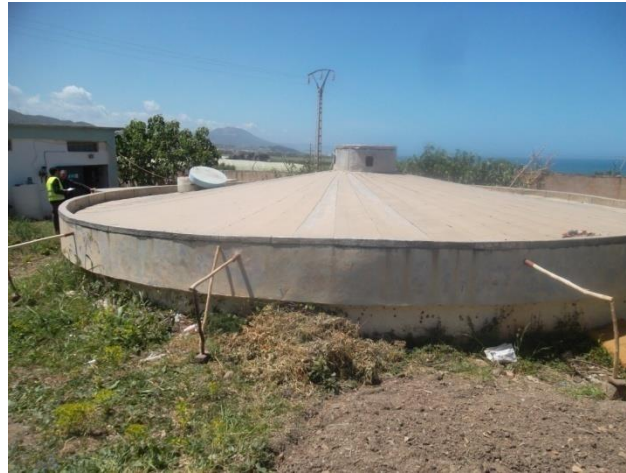
Figure 24 : Photo du réservoir Oued El Hammam Nord
