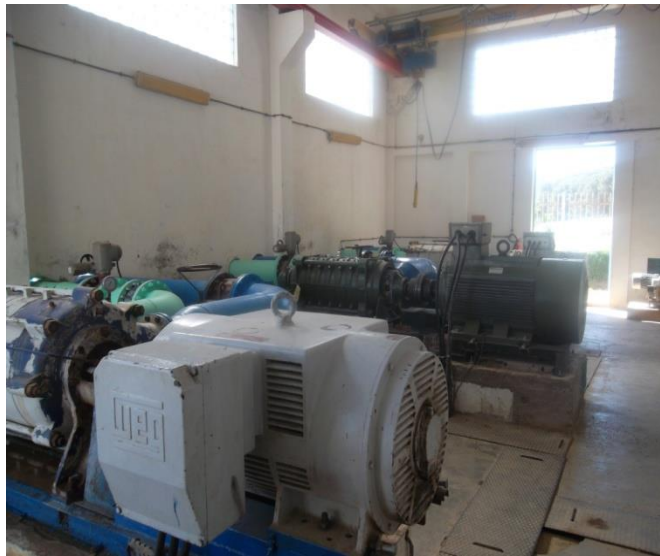
Figure 11 : Photo de la nouvelle station Oued El Bellah
