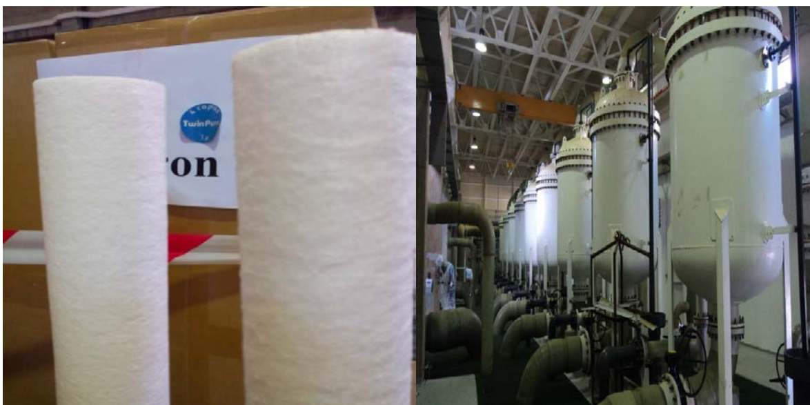
Figure IV.08 : L'unité des filtres à cartouches. (Propre Photo)
