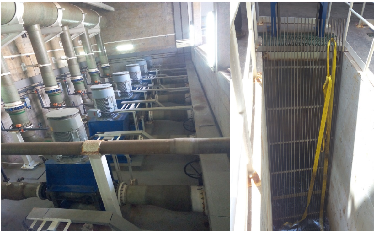
Figure IV.05 : Le dégrilleurs et la station de pompage. (Propre Photo)
