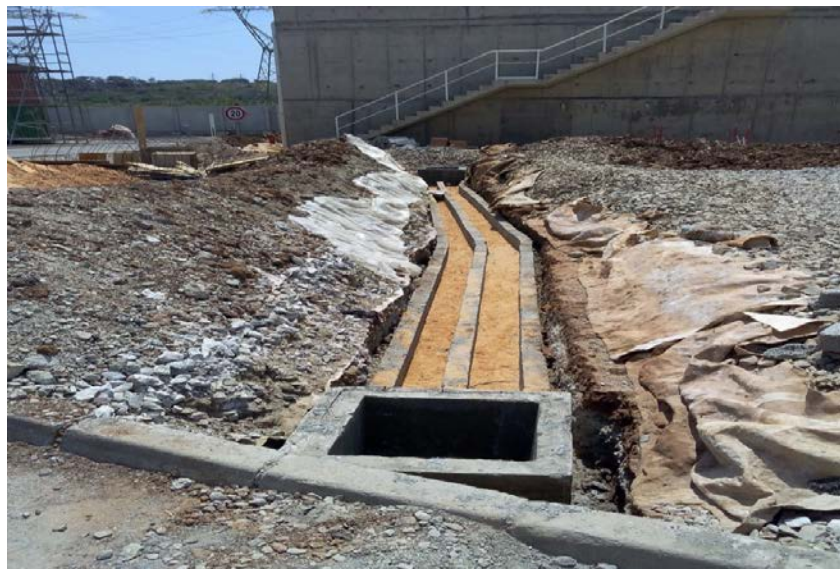
Figure V.04 : La nouvelle conduite d'eau de service. [Propre Photo]
