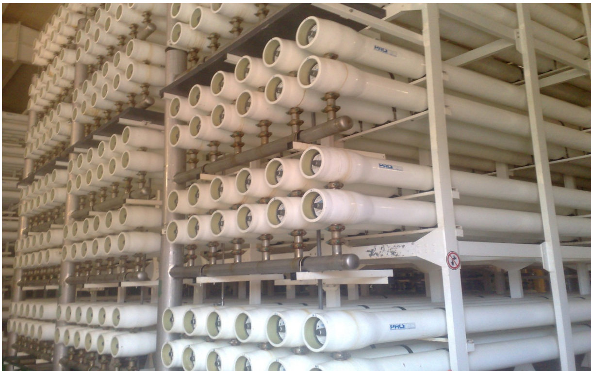
Figure IV.09 : Unité d'osmose inverse. (Propre Photo)
