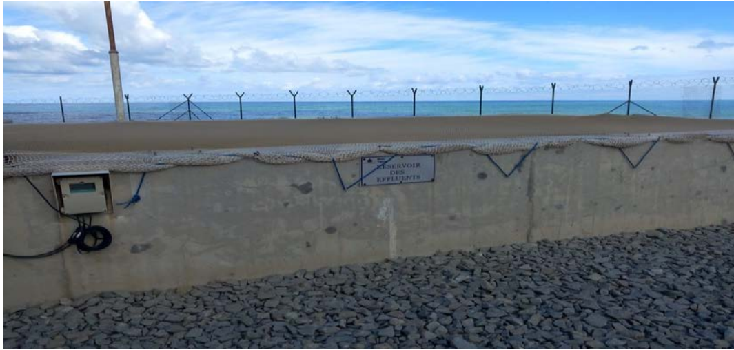
Figure V.05 : Le réservoir de traitement des effluents. [Propre Photo]
