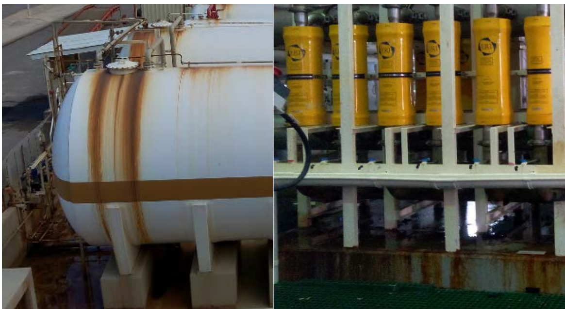
Figure V.01 : Quelques signes de corrosion au sein de la station. [Propre Photo]
