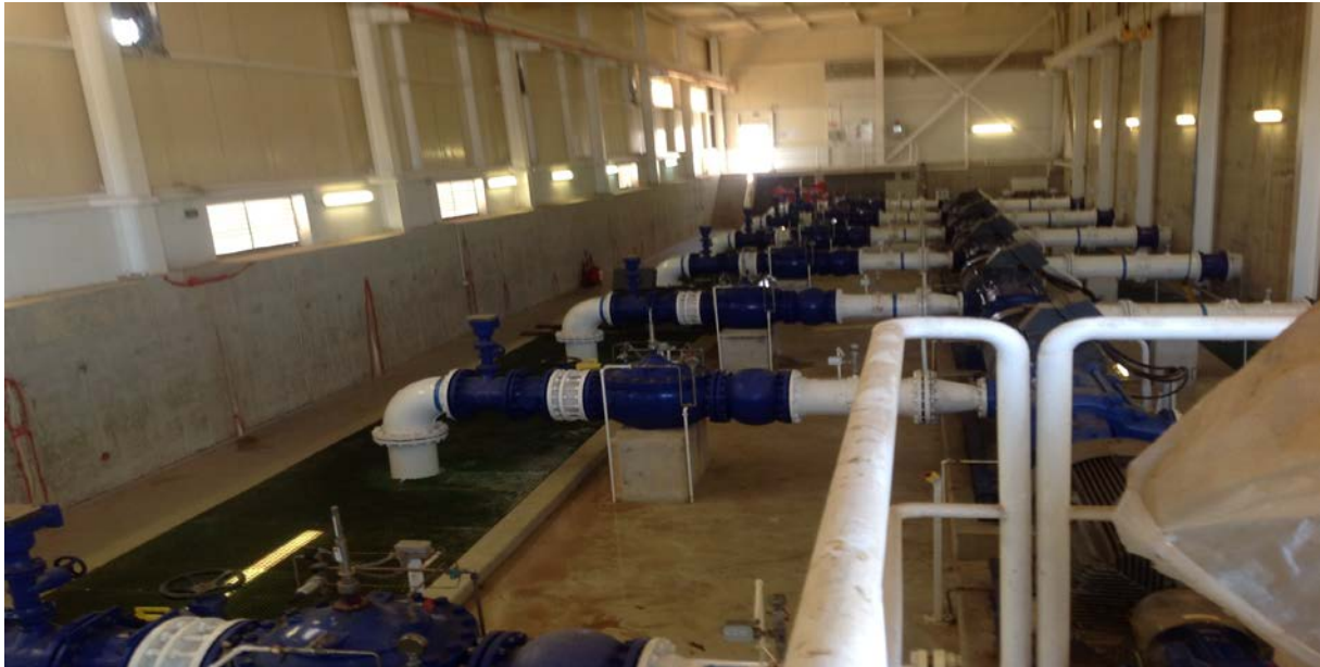
Figure IV-13 : Station de pompage d'eau traitée. (Propre Photo)
