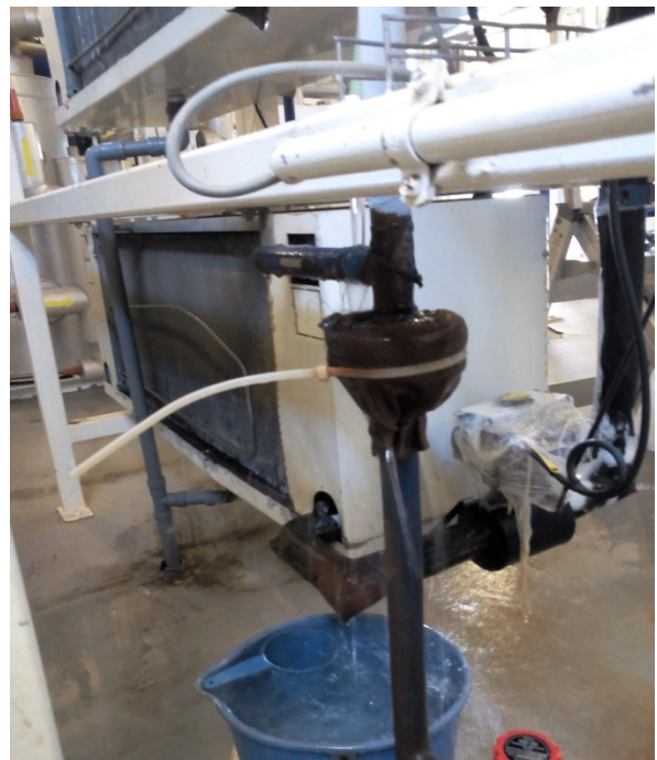
Figure V.03: Fuite dans le système de Production de CO2 [Propre Photo]
