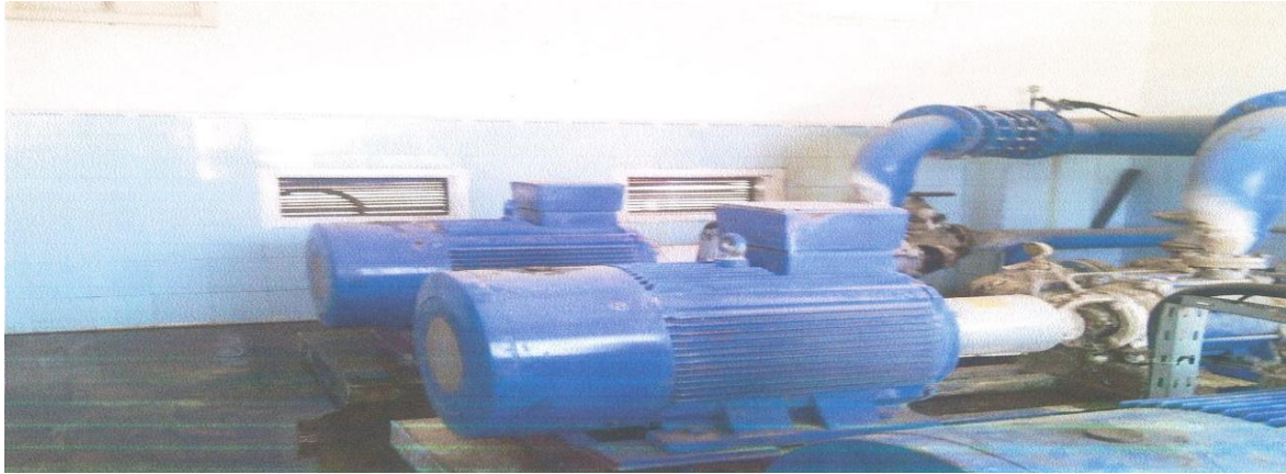
Figure 3.3 : les trois pompes identiques .
