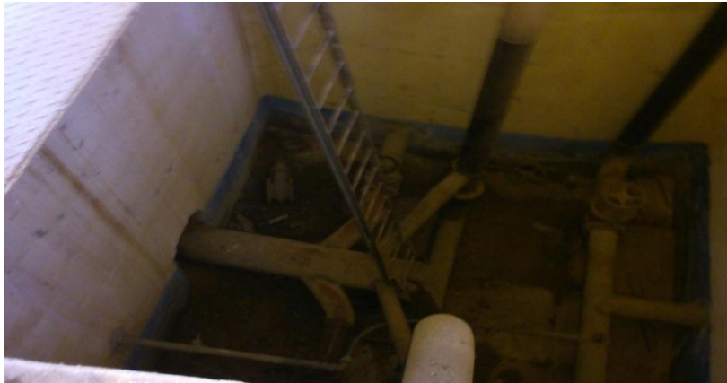
Figure 2.5 : équipement de canalisation d'un Réservoir.
