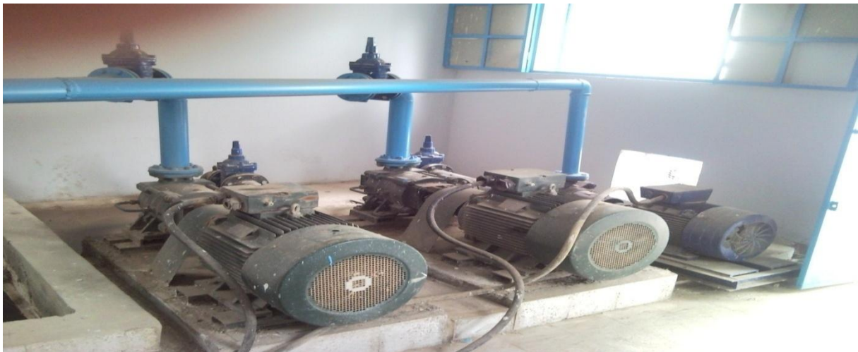
Figure 3.6 : Station de pompage d'oued ferdja.
